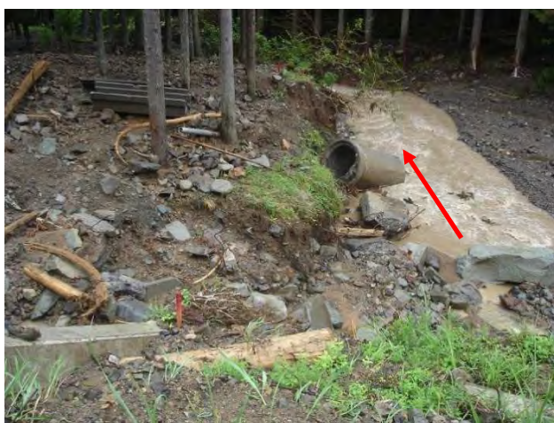
写真-2 護岸損壊 下流部に流失排水管
