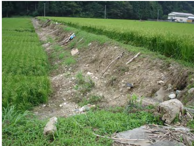
写真-3 右岸側越流区域 あぜ道の法面崩落
