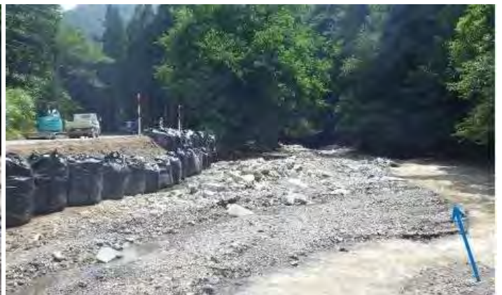
写真-3 護岸損壊 (福井県提供)
