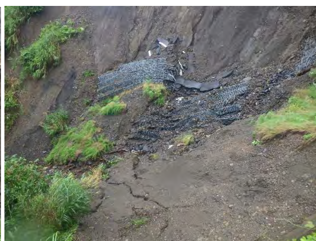
写真-12 崩壊斜面左側中段
