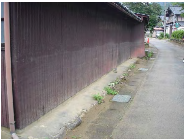
写真-2 建物の越流痕 (右岸側、深さ1m以上)
