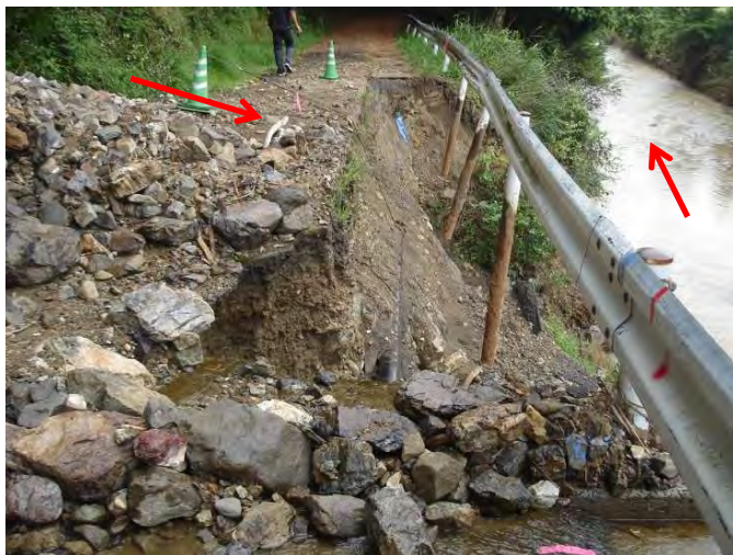
写真-3 土石流堆積物
