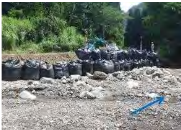
写真-2 護岸損壊 (福井県提供)
