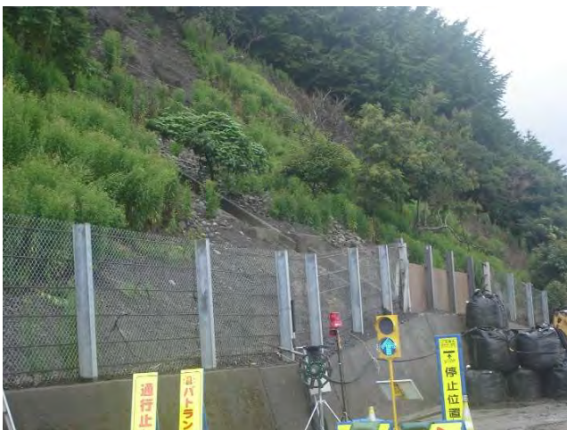
写真-6 表層崩壊
