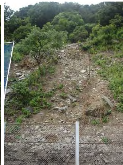
写真-5 斜面崩壊
