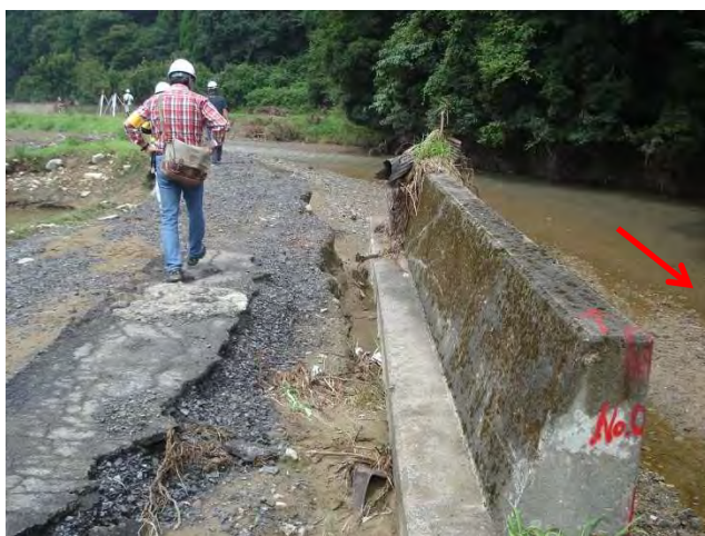
写真-7 護岸損壊
