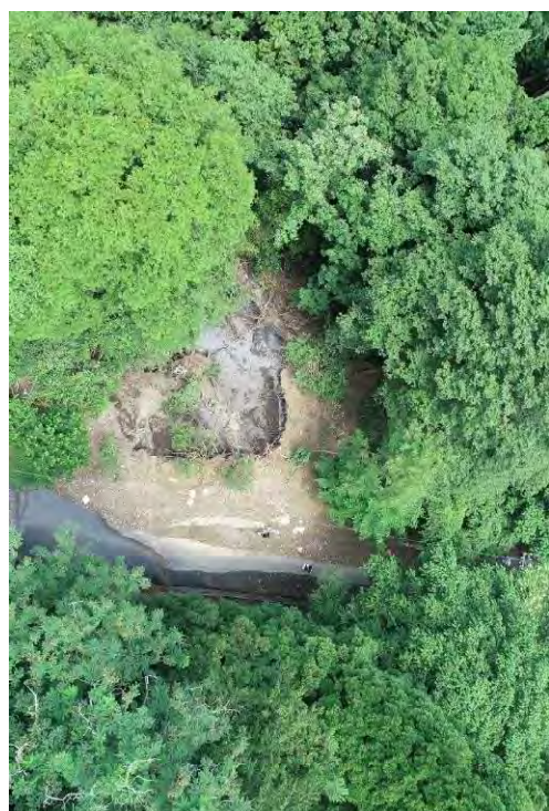
写真-2 道路右側の路肩崩壊全景（福井県提供）
