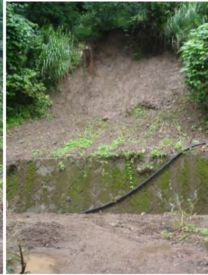
写真-6 付近の表層崩壊（擁壁損傷なし）
