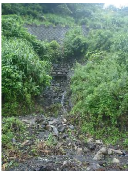
写真-8 沢からの土砂流出
