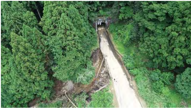
写真-2 道路右側の路肩崩壊全景 (福井県提供)
