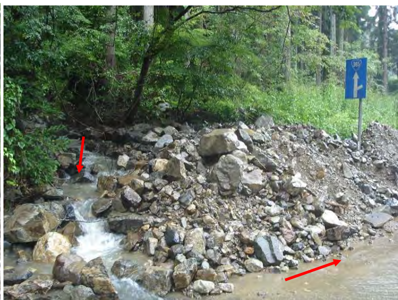
写真-3 沢からの土砂流出
