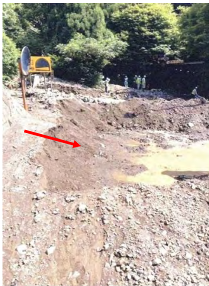
写真-5 土砂流出：福井河川国道
