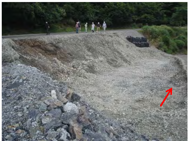
写真-5 路肩崩壊箇所とズリ仮置場
