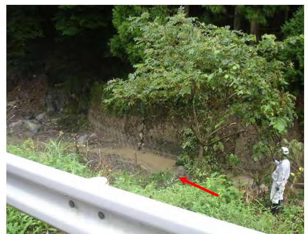
写真-7 左岸での護岸損傷
