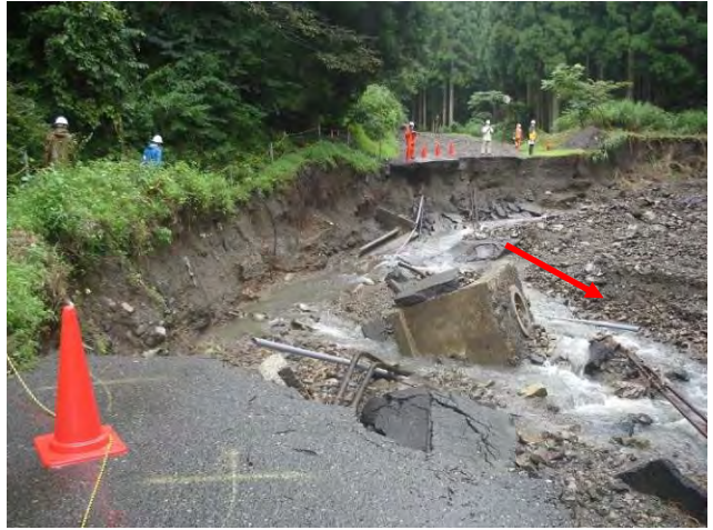
写真-8 道路損壊
