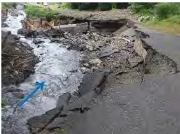
写真-2 道路損壊（福井県提供）
