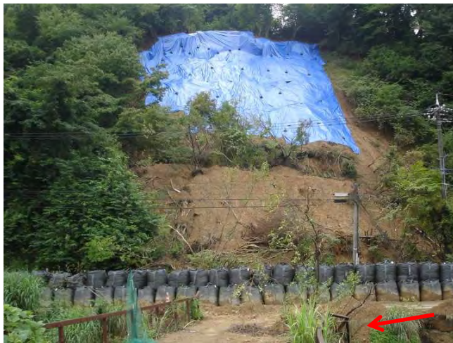
写真-2 斜面崩壊箇所
