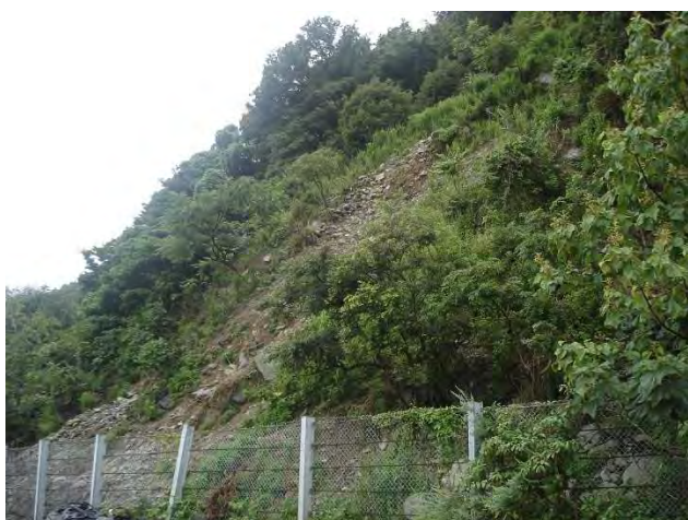
写真-4 斜面崩壊
