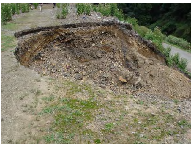
写真-2 道路右側の斜面崩壊
