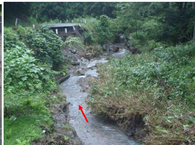
写真-5 護岸崩壊
