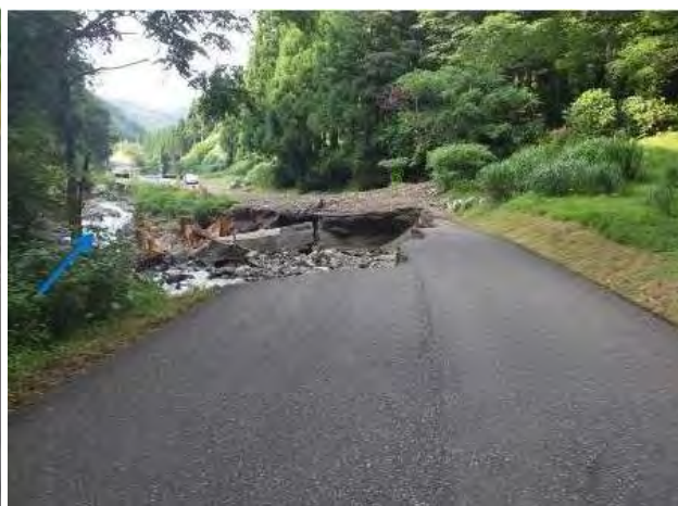
写真-3 道路損壊（福井県提供）
