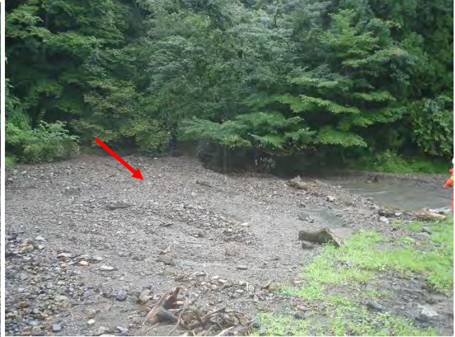
写真-3 土砂流出発生箇所付近
