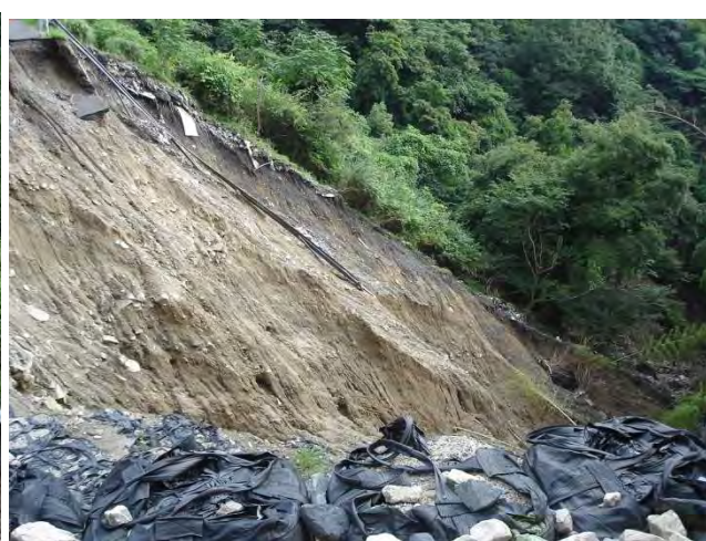
写真-17 道路右側の路肩崩壊（中段）
