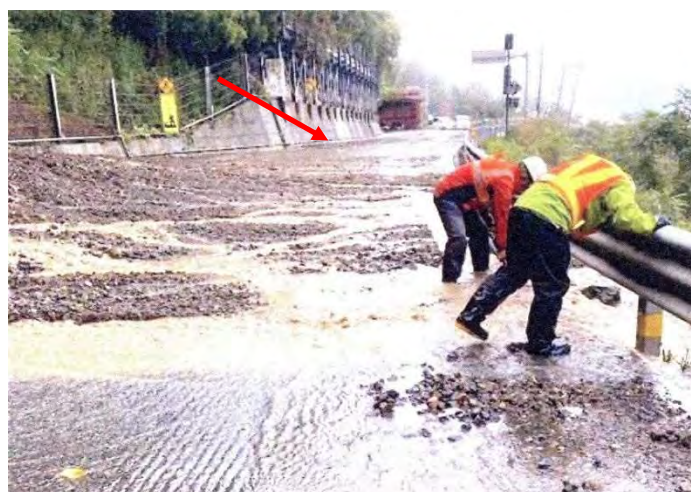
写真-3 土砂流出：福井河川国道
