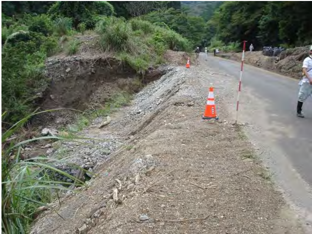
写真-2 路肩崩壊箇所
