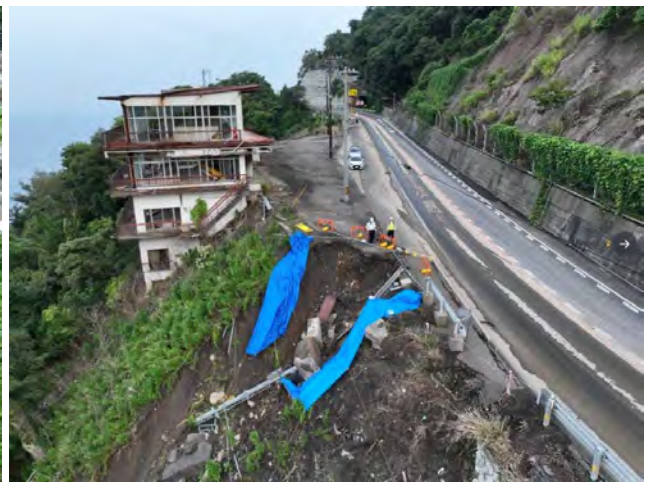
写真-3 福井側崩落面：福井河川国道 Twitter (8/6)
