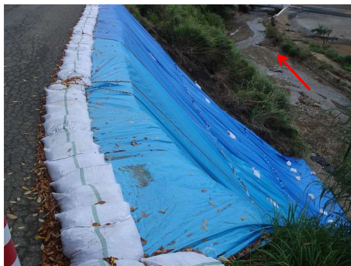
写真-3 路肩崩壊箇所
