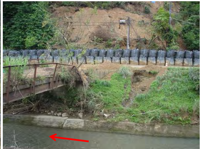
写真-3 斜面崩壊箇所下部
