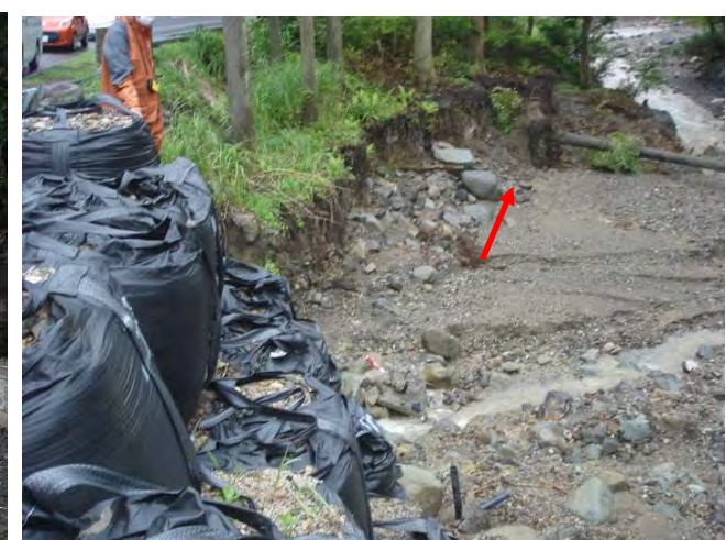
写真-5 護岸損壊
