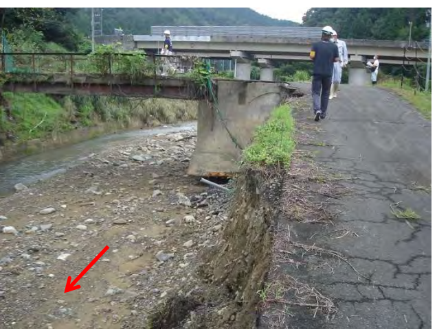
写真-9 橋台下部浸食と護岸損壊 橋梁下部
