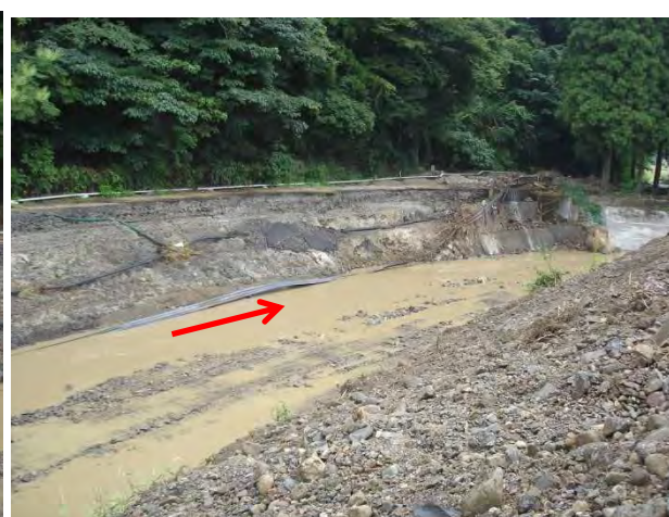
写真-7 土砂集積箇所下流部の道路部流失
