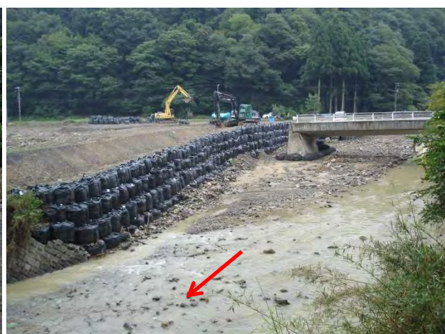
写真-12 下流側からみた損壊橋梁
