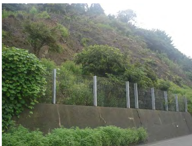
写真-11 表層崩壊
