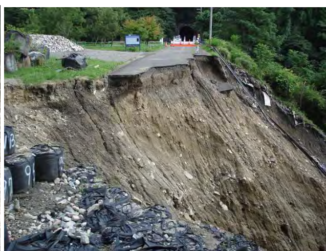
写真-15 道路右側の路肩崩壊
