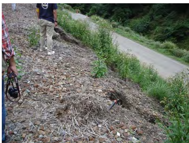
写真-3 道路右側の斜面崩壊
