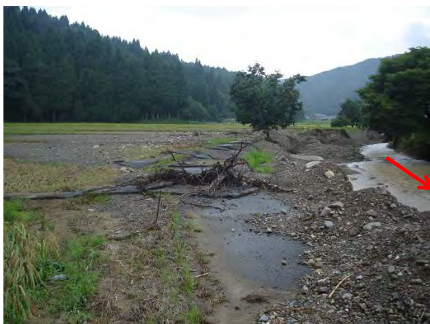
写真-12 土砂堆積箇所 舗装損傷
