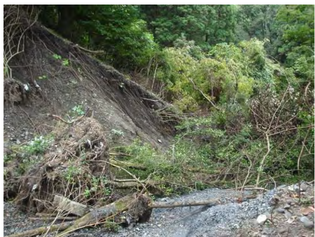
写真-8 道路右側の路肩崩壊下部
