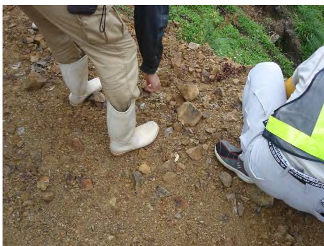
写真-4 斜面崩壊土砂
