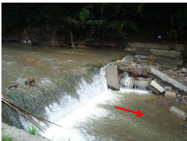
写真-6 落差工と上流からの損壊物の体積
