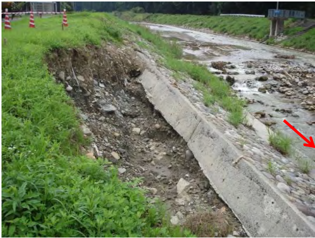
写真-10 陥没箇所. (上部から)
