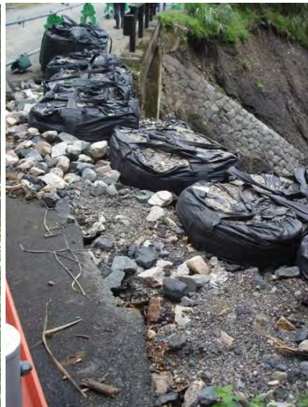
写真-5 道路右側の路肩崩壊
