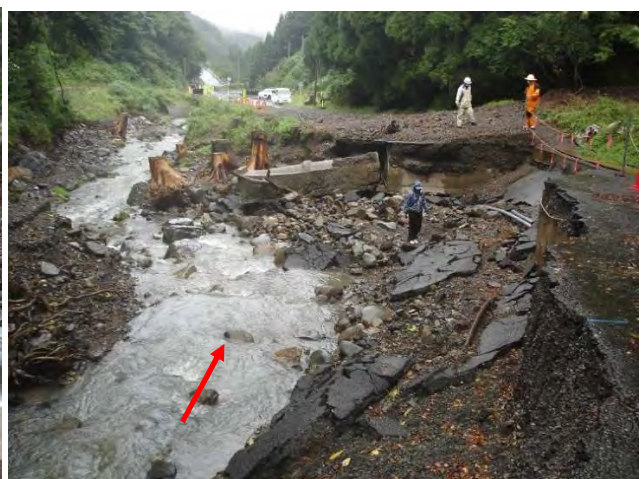
写真-9 道路損壊
