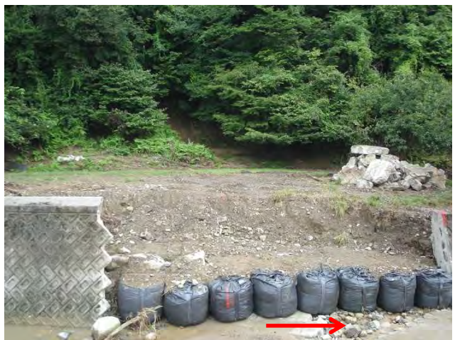
写真-5 護岸損壊 (左岸側)
