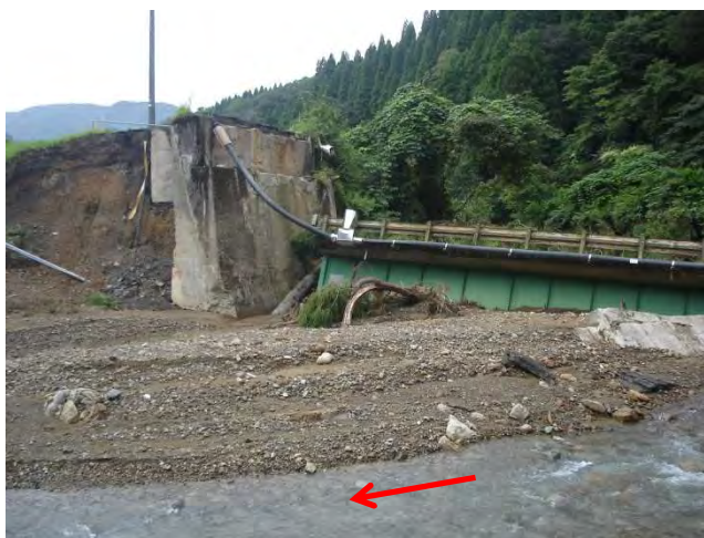
写真-4 下流からみた橋梁損壊箇所
