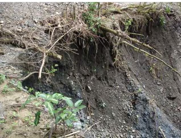
写真-7 道路右側の路肩崩壊
