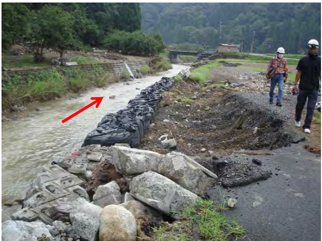
写真-4 越流浸食痕
