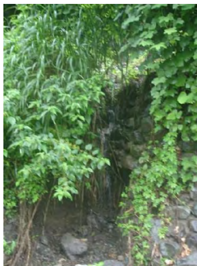
写真-11 沢からの土砂流出
