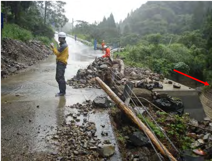
写真-4 土砂堆積
