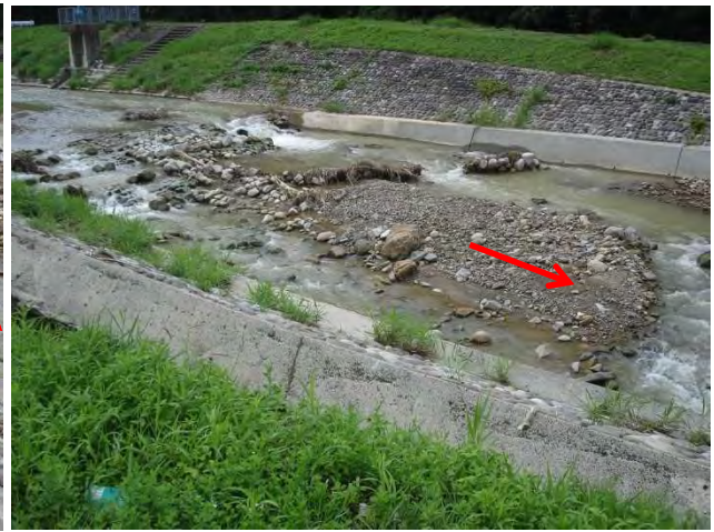
写真-11 陥没箇所.上流部の落差工
