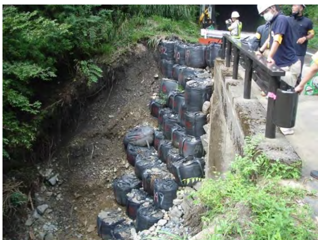
写真-6 道路右側の路肩崩壊
