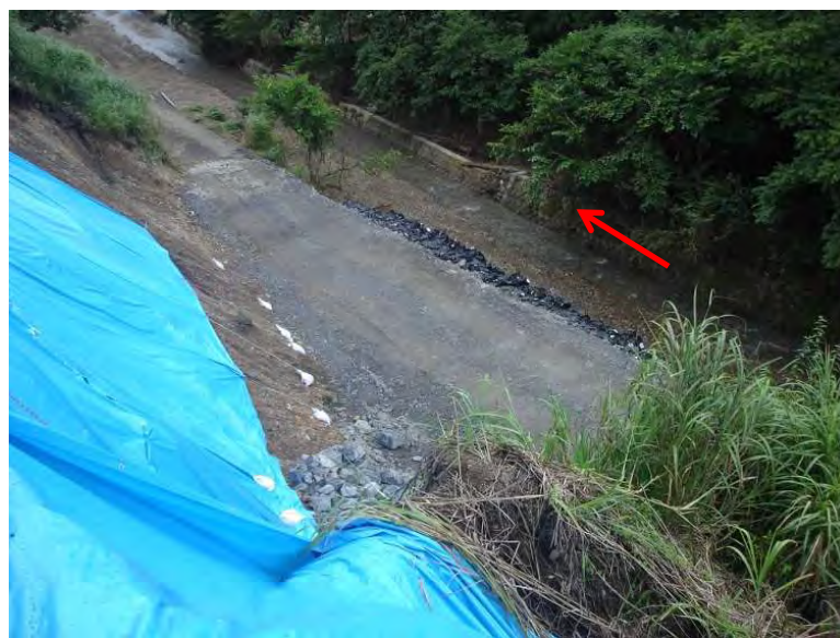
写真-3 路肩崩壊箇所中段
