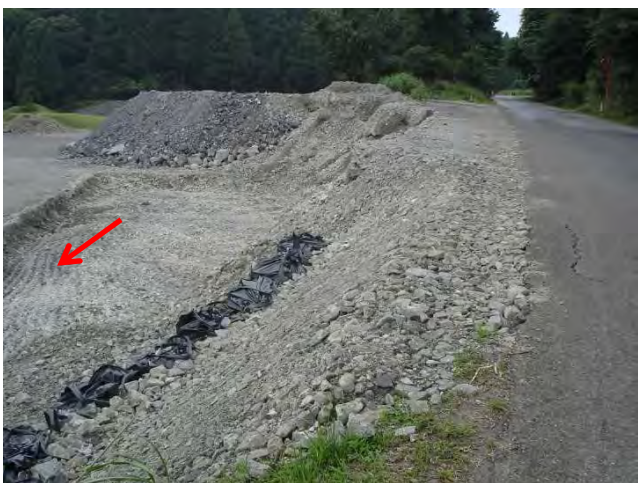
写真 4 -路肩崩壊箇所 (掘削ズリで盛土) とズリ仮置場
