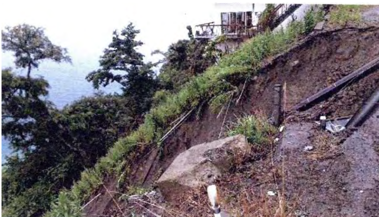
写真-4 福井側崩落面の拡大：福井河川国道
