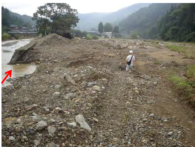
写真-14 土砂堆積箇所 護岸損傷
