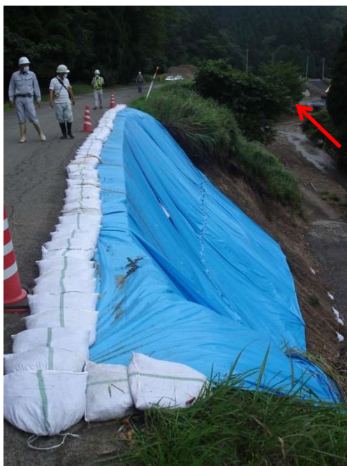
写真-2 路肩崩壊箇所
