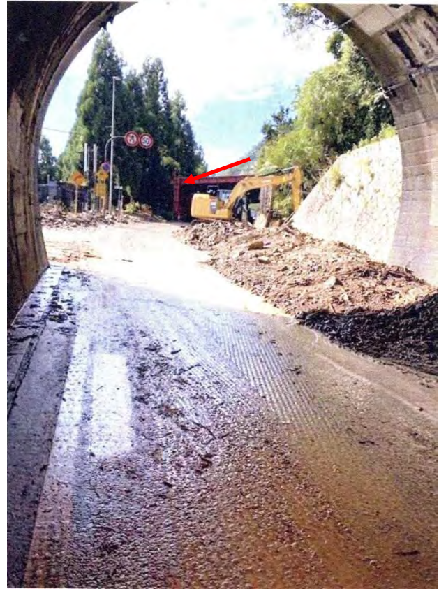
写真-3 土砂流出：福井河川国道
