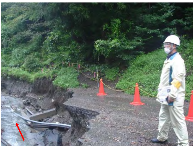
写真-4 沢部の状況と道路損壊
