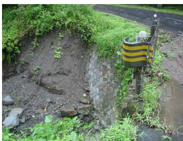
写真-4 護岸崩壊
