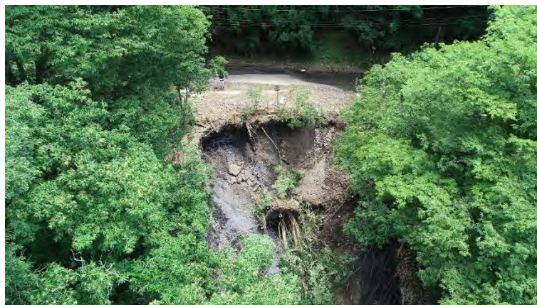
写真-3 道路右側の路肩崩壊全景（福井県提供）
