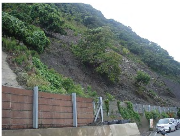
写真-9 隣接斜面崩壊
