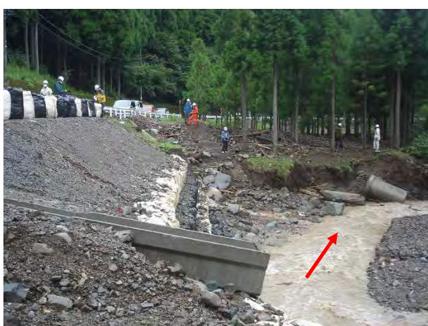
写真-3 護岸損壊 左岸からの排水工
