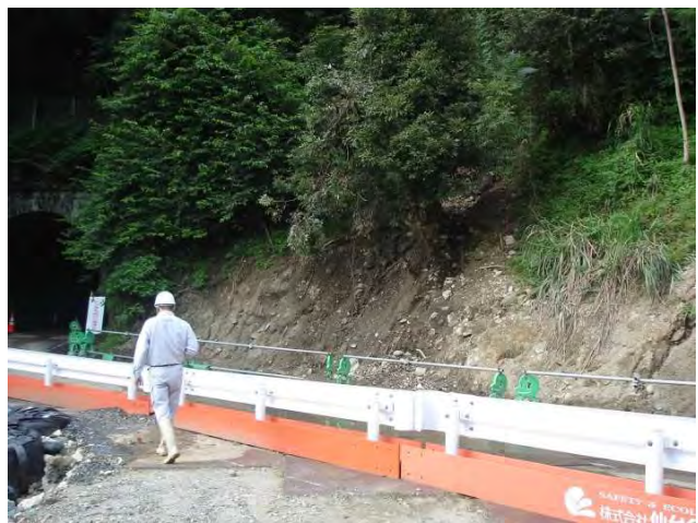
写真-5 道路左側の土石流痕
