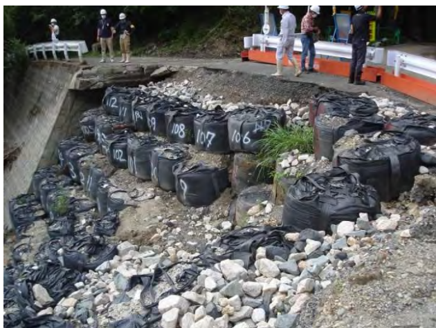
写真-12 道路右側の路肩崩壊
