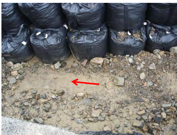
写真-7 損壊橋梁 右岸側の橋台側部
