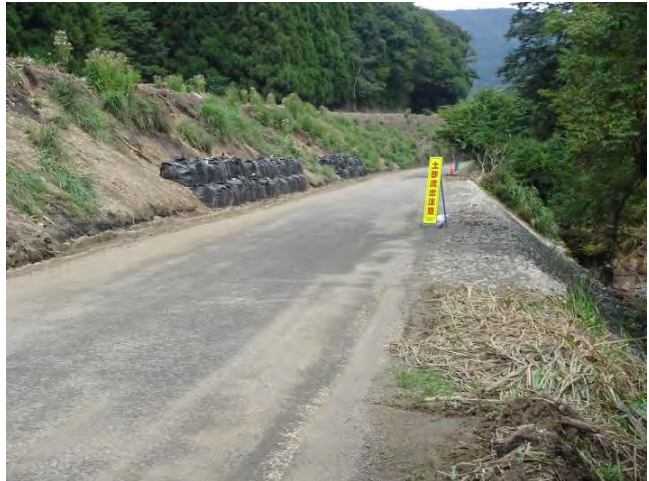
写真-3 道路右側の斜面崩壊と左側の路肩崩壊
