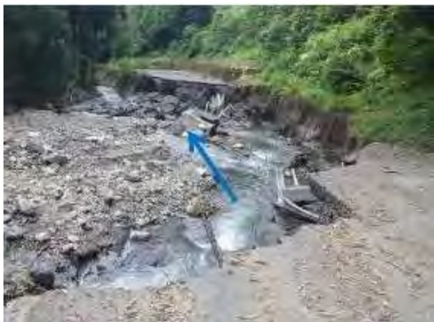
写真-1 道路損壊（福井県提供）
