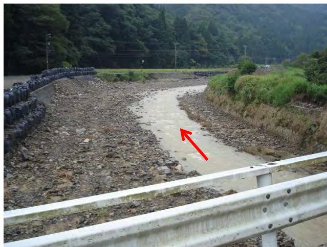
写真-10 損壊橋梁 下流部
