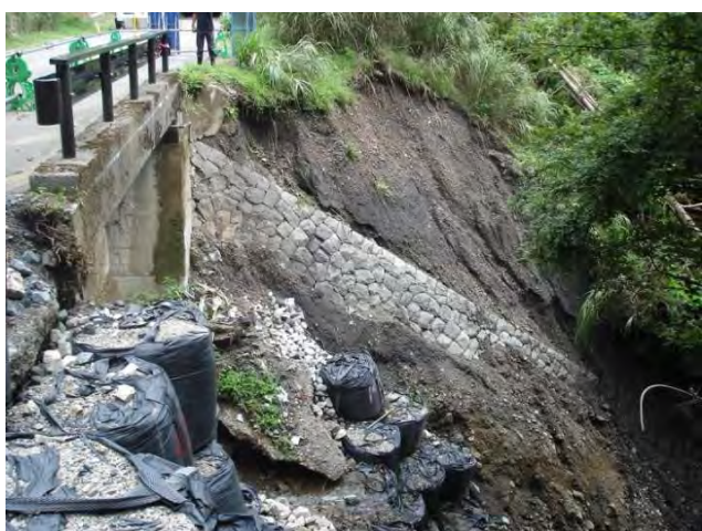
写真-8 道路右側の路肩崩壊
