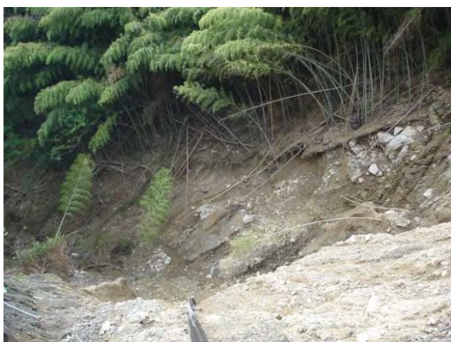
写真-14 道路右側の路肩崩壊（下段）
