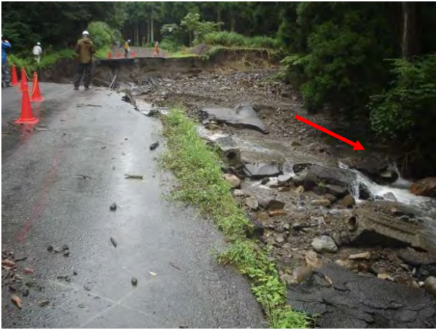
写真-7 道路損壊
