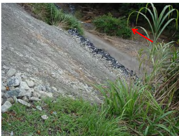
写真-4 路肩崩壊箇所下段 下に別工事用仮設道路
