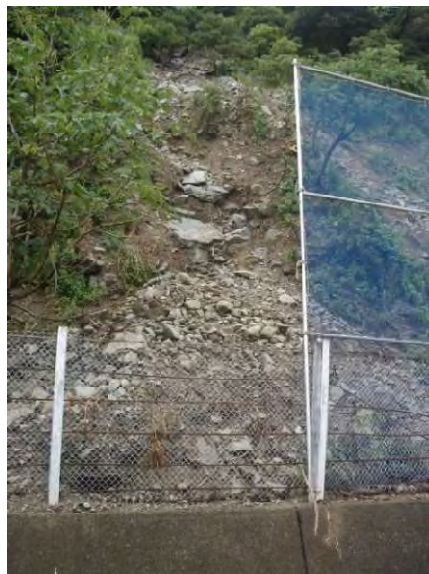
写真-7 斜面崩壊
