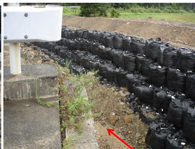
写真-8 損壊橋梁 右岸側の橋台側部
