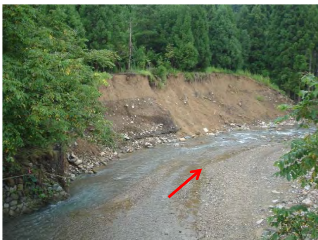
写真-3 橋梁損壊箇所下流での斜面崩落（下部洗掘）
