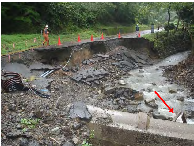
写真-8 道路損壊
