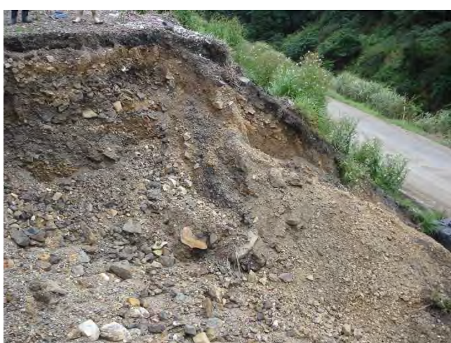
写真-4 道路右側の斜面崩壊
