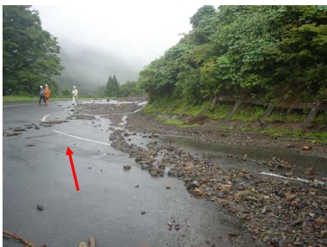
写真-6 土砂流出箇所から下流への土砂の流れ
