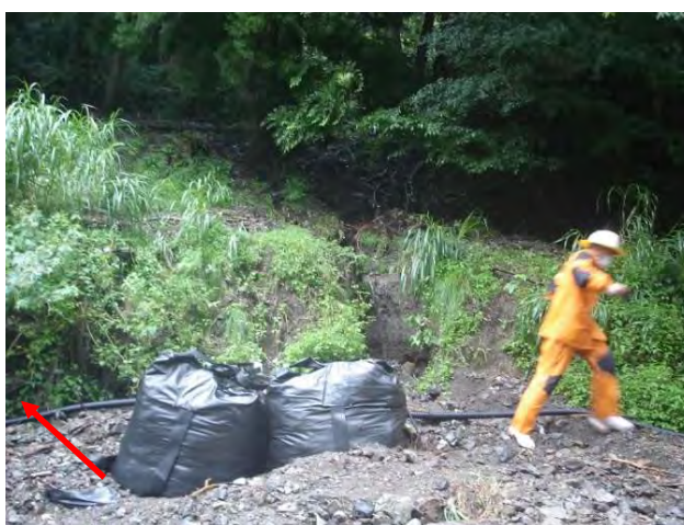
写真-5 沢部の状況
