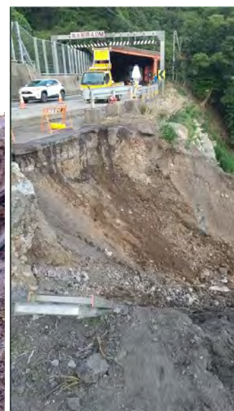
写真-5 敦賀側崩落面：福井河川国道 Twitter (8/12)
