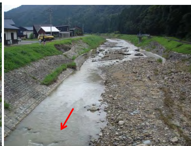
写真-7 橋梁 A の上流側 (左端に陥没箇所)
