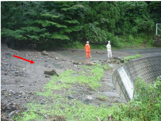
写真-4 土砂流出発生箇所付近
