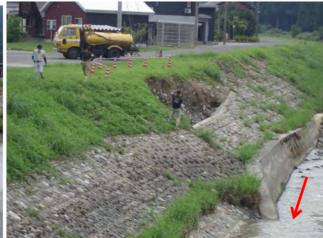
写真-9 陥没箇所
