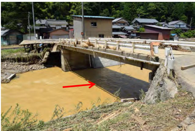
写真-4 災害直後の橋梁 B
