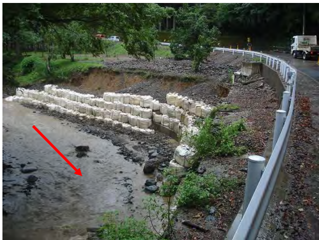
写真-2 護岸損壊
