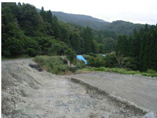
写真-5 複数の路肩崩壊箇所の遠景
