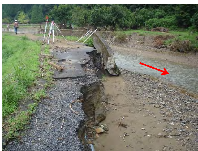
写真-8 護岸損壊
