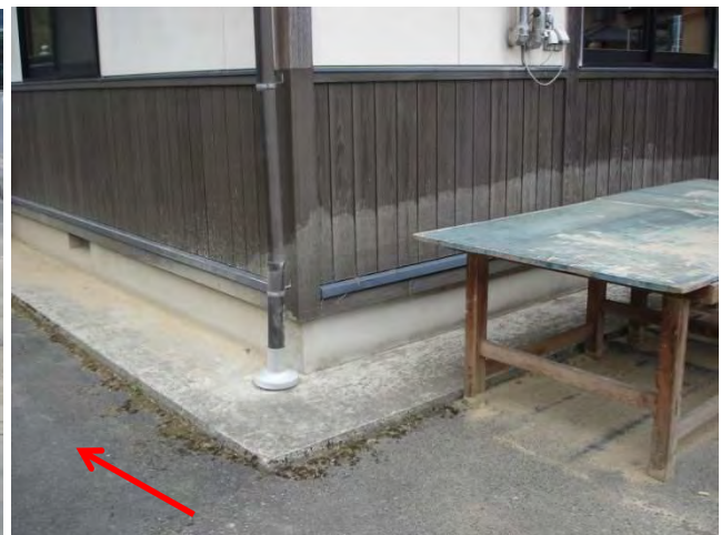
写真-13 集会所の越流痕 (高さ約 1m)
