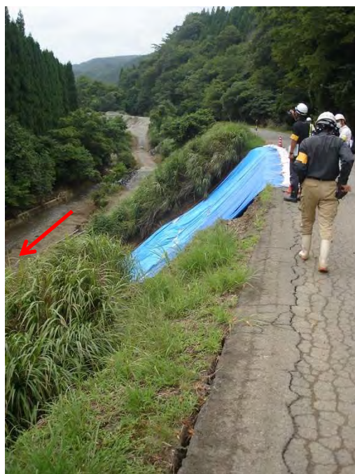
写真-2 路肩崩壊箇所
