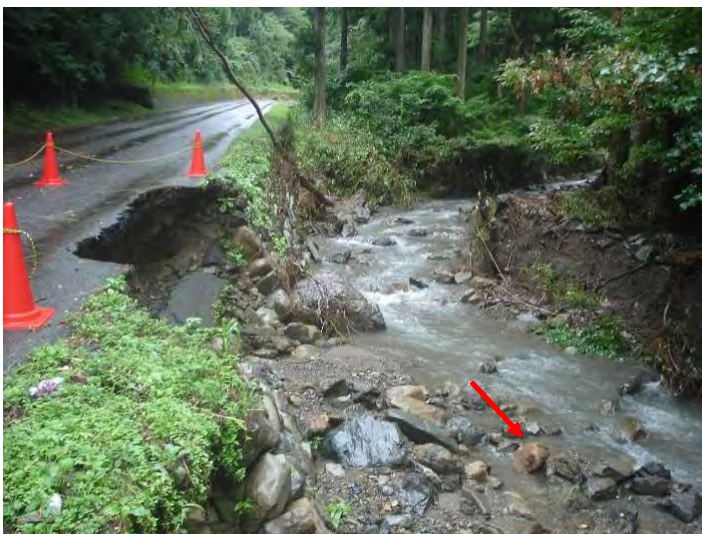
写真-3 護岸崩壊
