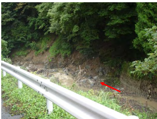
写真-6 右岸での河岸浸食
