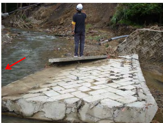
写真-7 左岸側護岸の流失
