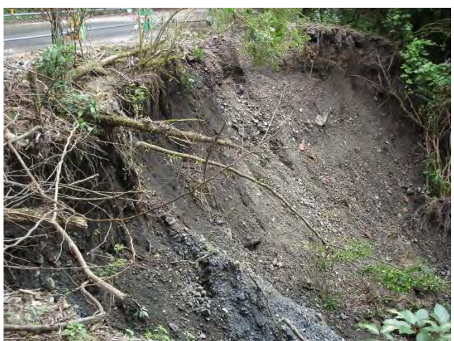
写真-6 道路右側の路肩崩壊
