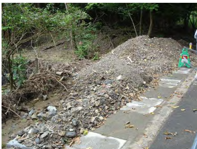
写真-12 上流部での土石流
