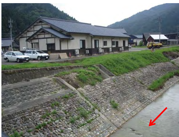
写真-8 集会所 (右端に陥没箇所)
