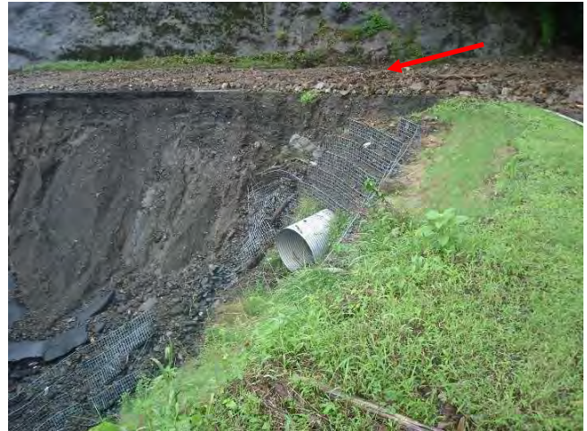
写真-14 崩壊斜面と排水管
