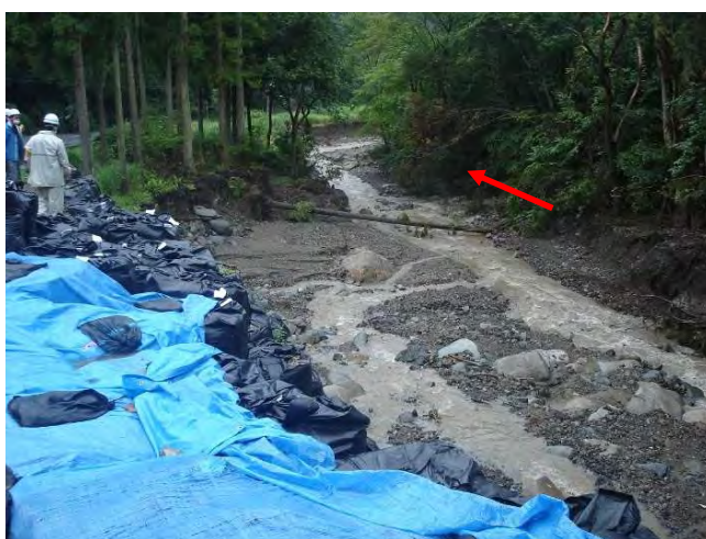
写真-4 護岸損壊
