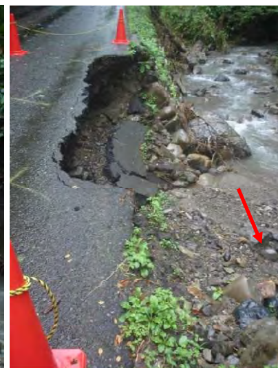
写真-4 護岸崩壊
