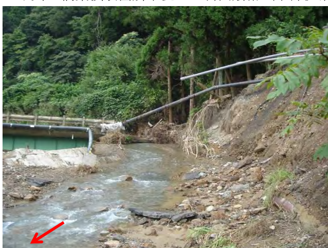
写真-5 下流からみた橋梁損壊箇所
