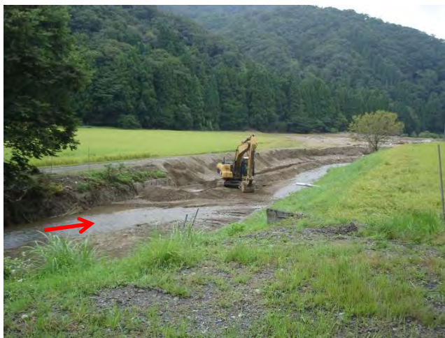
写真-11 斜面崩壊箇所の下流部 (河岸浸食)
