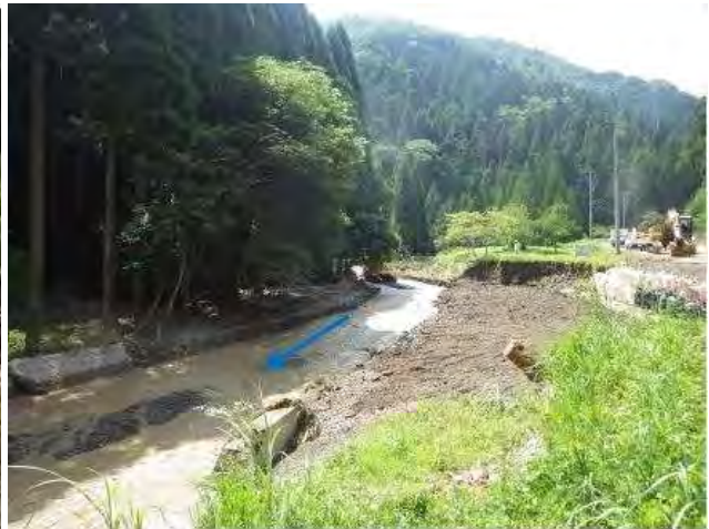
写真-3 護岸損壊（福井県提供）
