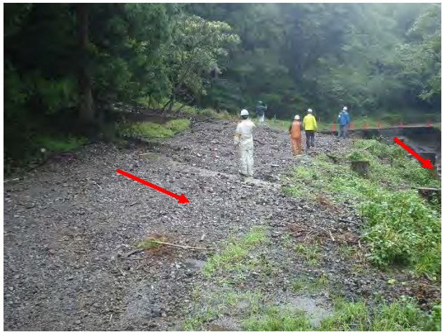
写真-7 沢、水路からの流出土砂
