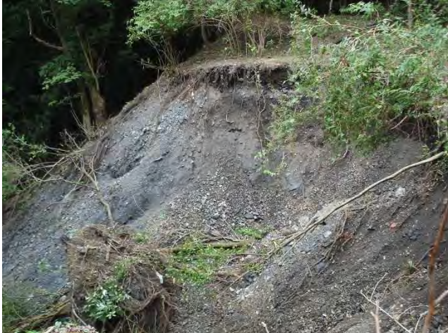
写真-9 道路右側の路肩崩壊
