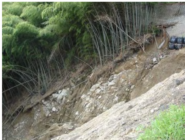
写真-13 道路右側の路肩崩壊（中段）
