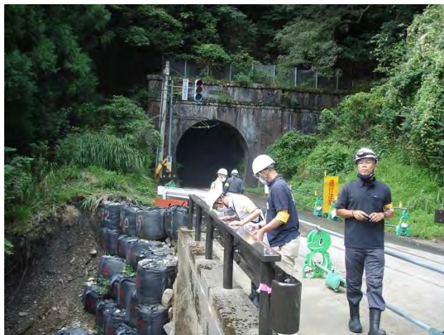
写真-7 道路右側の路肩崩壊
