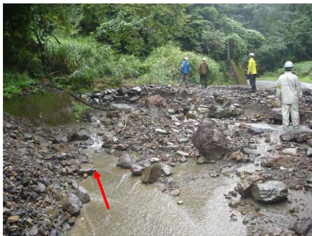
写真-11 道路損壊
