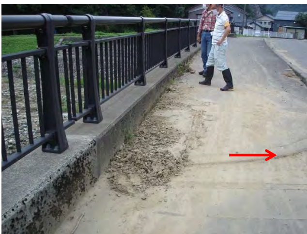
写真-12 橋梁 A 上の土砂痕跡
