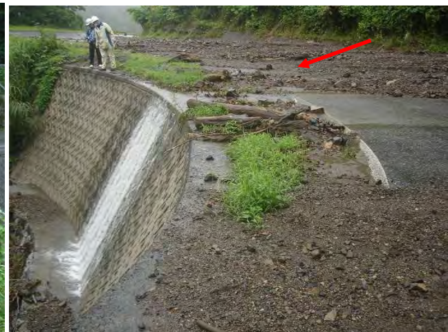
写真-5 流出土砂の堆積（排水路閉塞？）
