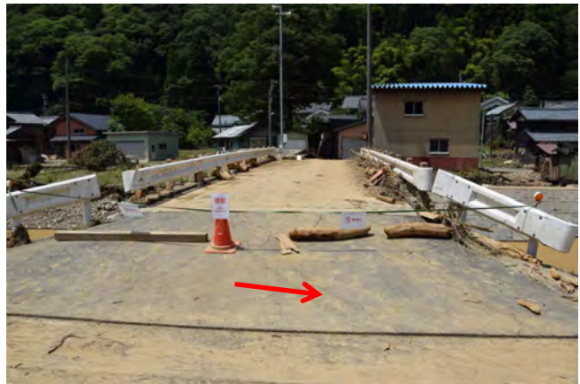
写真-3 災害直後の橋梁 B
