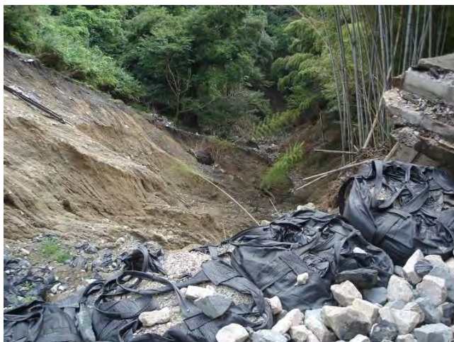
写真-18 道路右側の路肩崩壊（下段）
