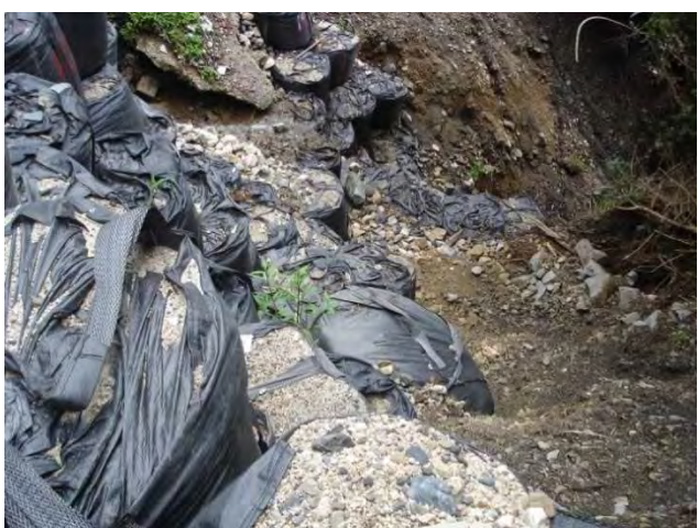
写真-9 道路右側の路肩崩壊下部
