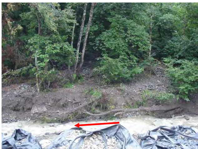
写真-2 右岸での河岸浸食
