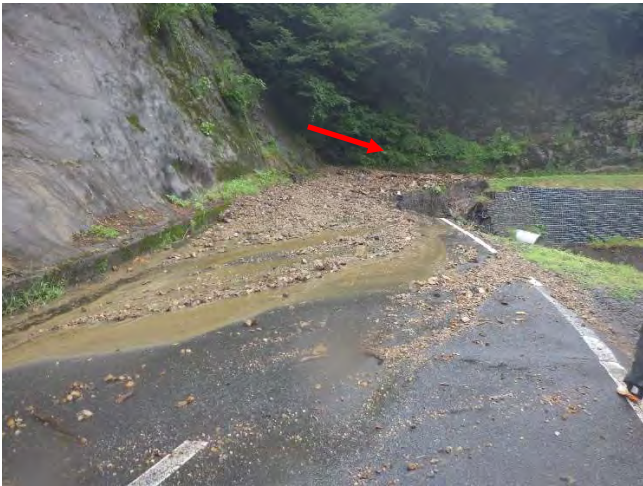
写真-3 沢からの土砂流出
