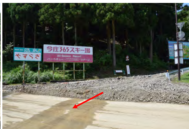
写真-3 土砂流出（災害直後）
