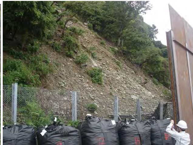
写真-7 斜面崩壊
