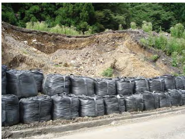
写真-6 道路右側の斜面崩壊
