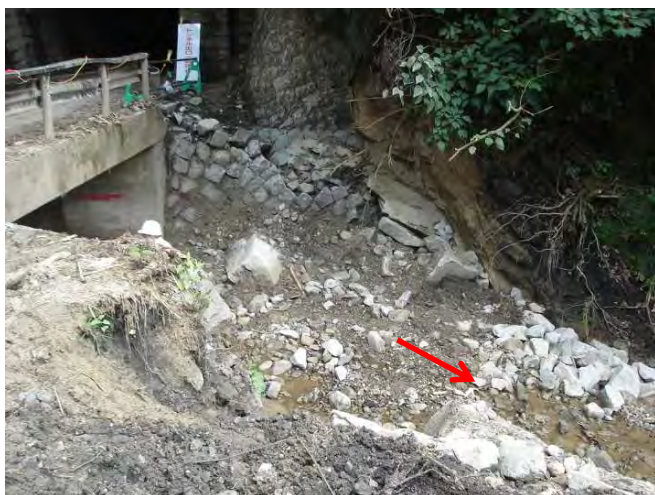
写真-4 道路右側（下流側）の溪流部損壊
