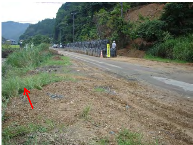
写真-8 斜面崩壊箇所 遠景
