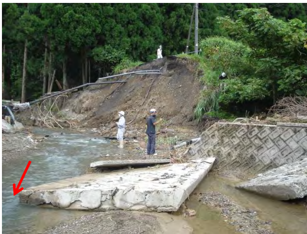
写真-8 左岸側護岸の流失
