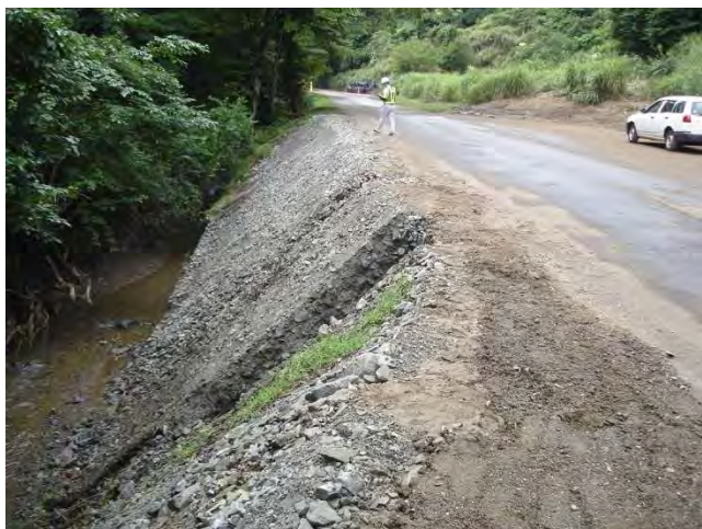
写真-2 路肩崩壊箇所
