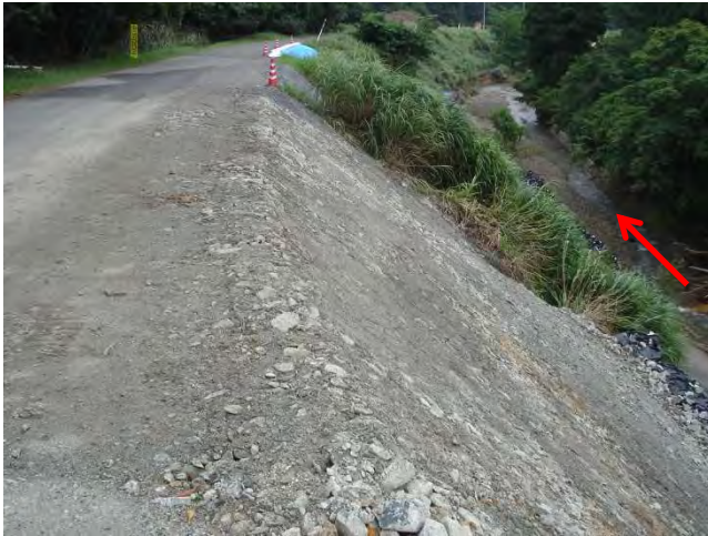
写真-2 路肩崩壊箇所 (掘削ズリで盛土)
