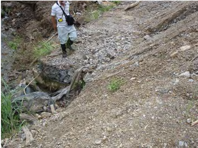
写真-2 道路左側の路肩崩壊箇所
