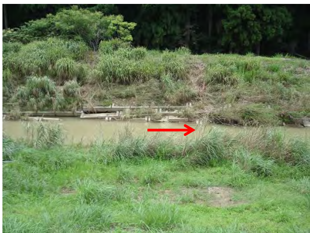
写真-2 護岸損壊
