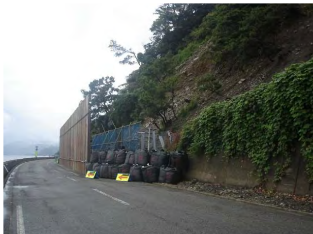
写真-5 斜面崩壊
