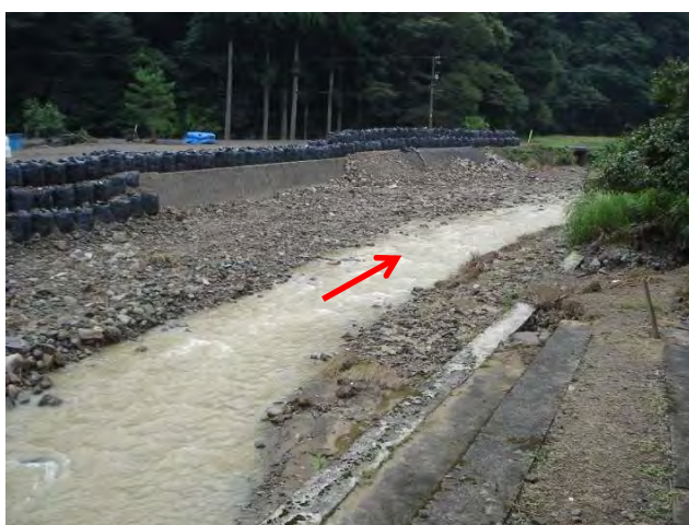
写真-11 損壊橋梁 下流部
