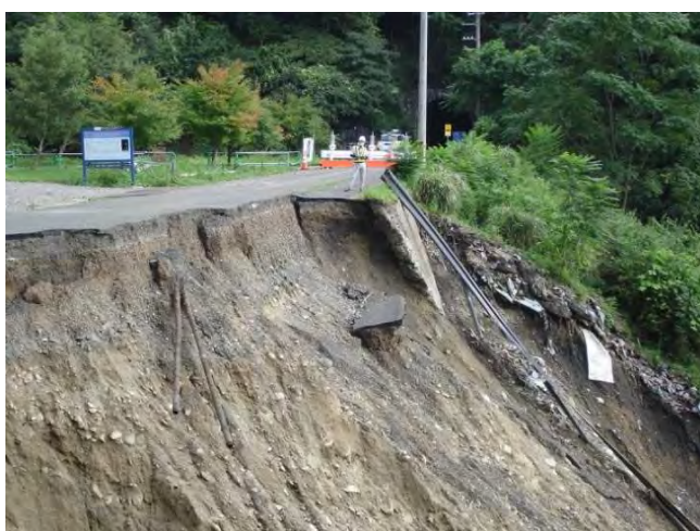
写真-16 道路右側の路肩崩壊
