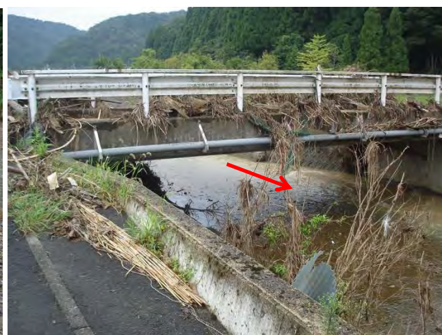
写真-9 橋梁上の堆積
