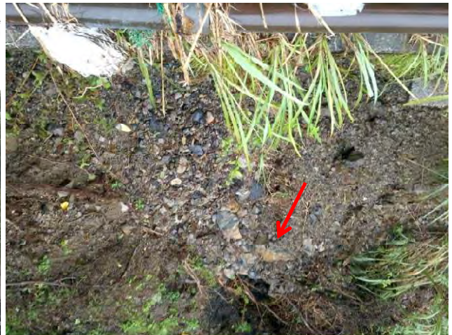
写真-7 写真-6 の表層崩壊①
