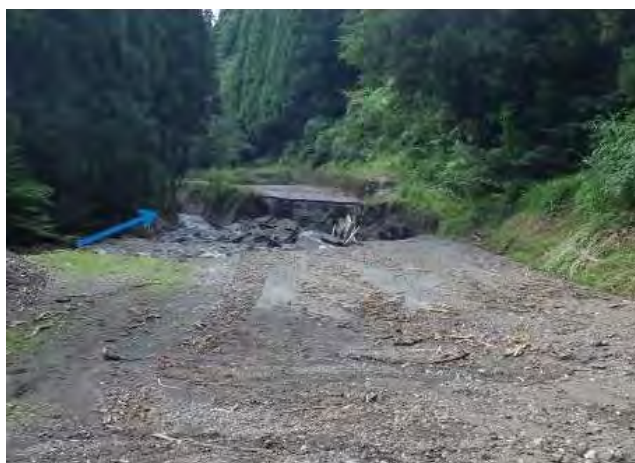
写真-2 道路損壊（福井県提供）
