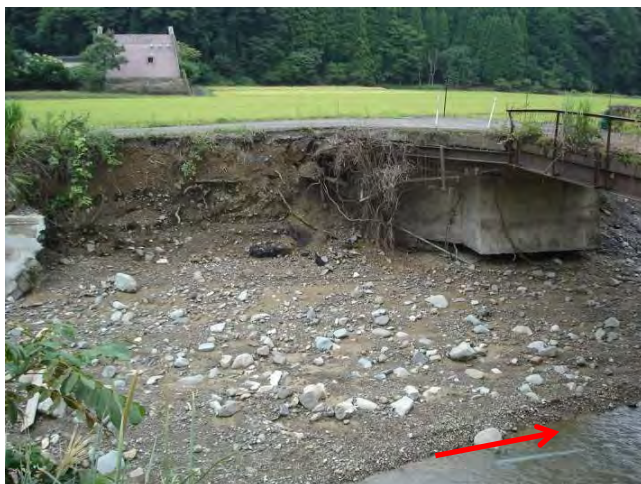
写真-10 橋台下部浸食と護岸損壊 橋梁上流部
