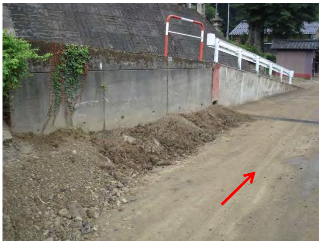
写真-15 橋梁 B から下流部 越流土砂と越流痕
