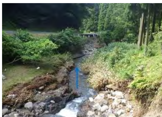
写真-3 護岸崩壊 (福井県提供)
