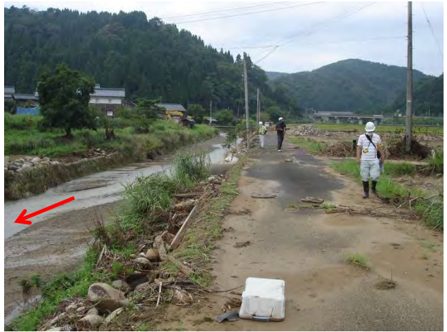
写真-13 護岸損壊（左岸側）
