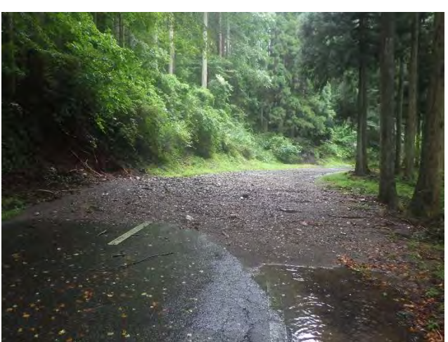
写真-7 沢からの土砂流出
