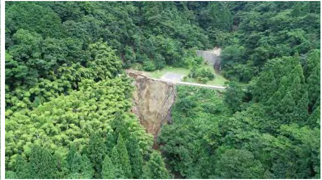
写真-3 道路右側の路肩崩壊全景（福井県提供）
