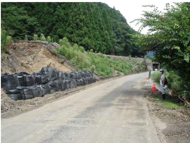
写真-4 道路右側の斜面崩壊
