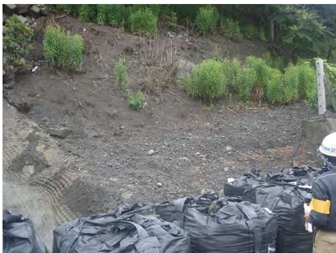
写真-6 水路周辺の土砂流出
