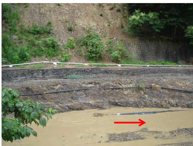
写真-6 土砂集積箇所下流部の崩壊斜面と道路部流失
