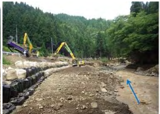
写真-3 護岸損壊 (福井県提供)
