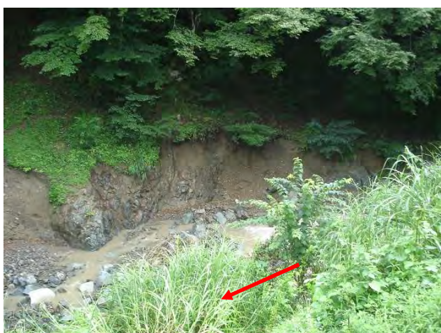
写真-4 右岸での河岸浸食
