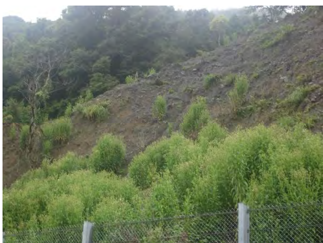
写真-10 表層崩壊
