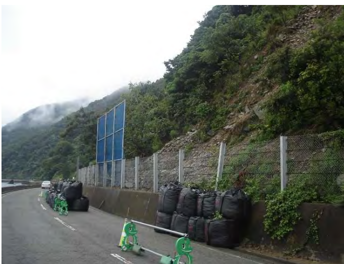
写真-4 斜面崩壊
