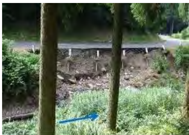
写真-2 護岸崩壊 (福井県提供)
