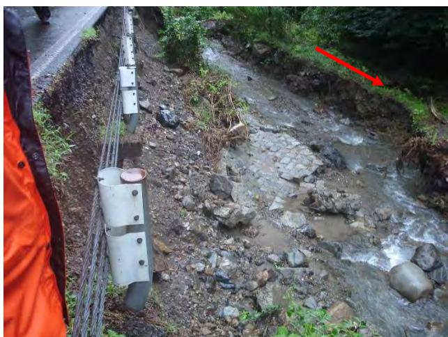
写真-6 護岸崩壊
