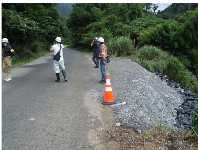
写真-2 路肩崩壊箇所
