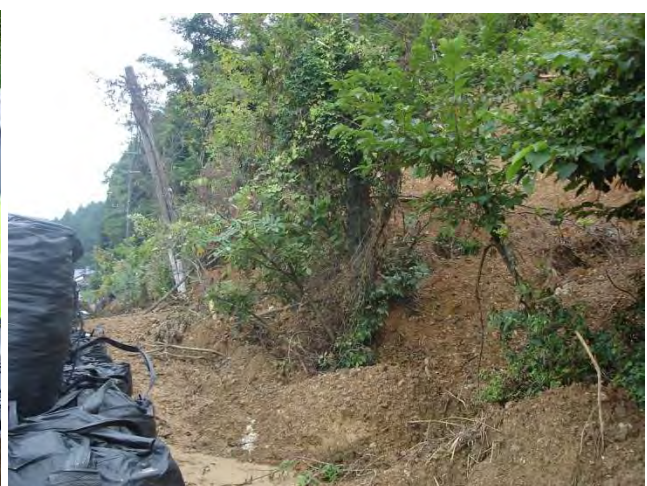
写真-5 斜面崩壊箇所下部 土のう背後
