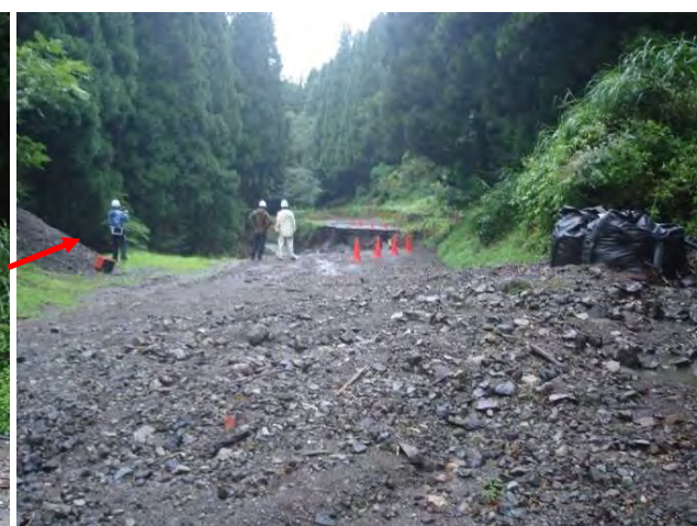
写真-6 沢部の状況
