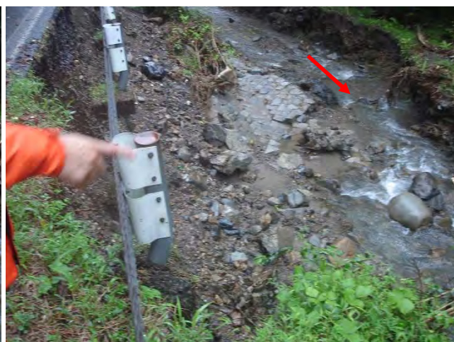
写真-7 護岸崩壊
