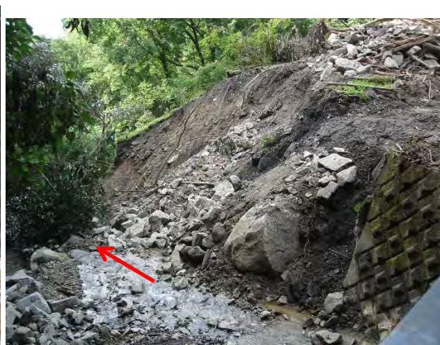
写真-5 道路右側の溪流部損壊
