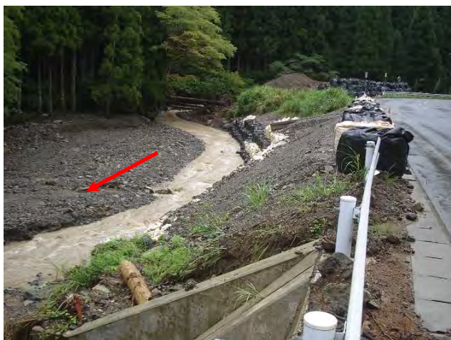
写真-1 護岸損壊
