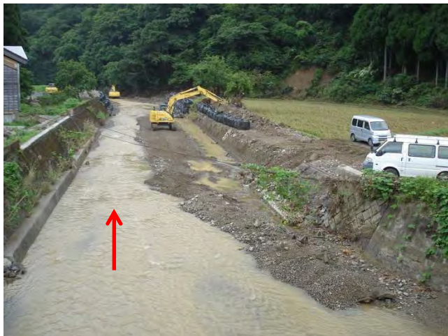
写真-2 土砂堆積箇所の下流部（集落）
