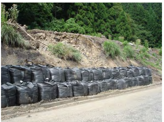
写真-5 道路右側の斜面崩壊
