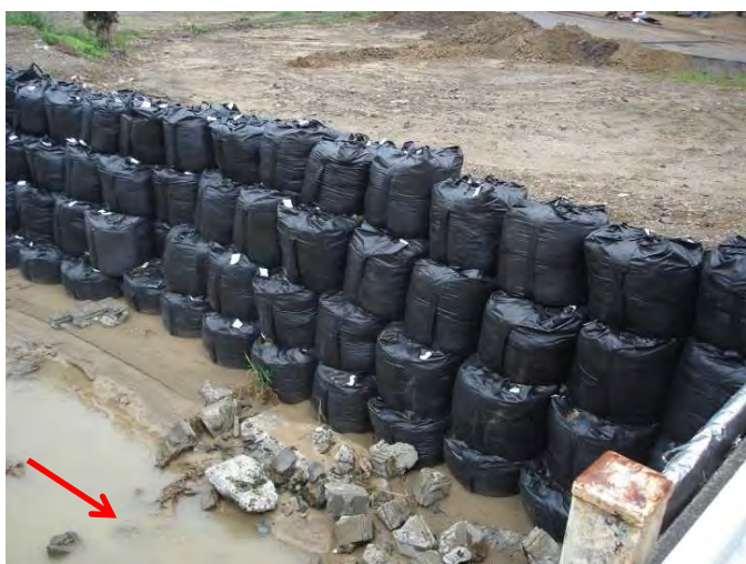
写真-8 橋梁 B から上流部の越流痕
