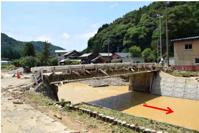
写真-2 災害直後の橋梁 B
