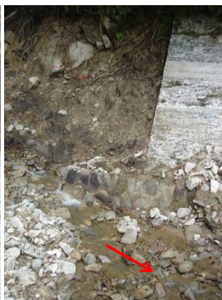
写真-3 道路左側溪流部の護岸損壊と埋まり
