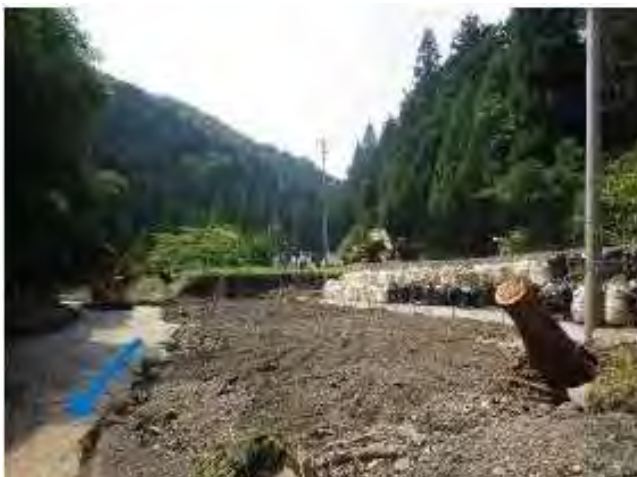
写真-2 護岸損壊（福井県提供）
