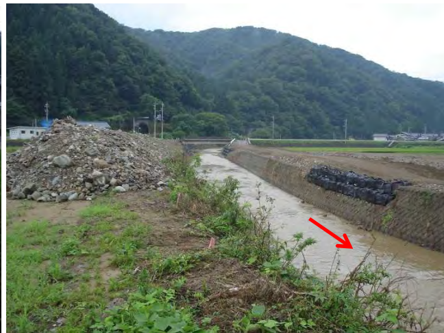
写真-5 土砂堆積箇所
