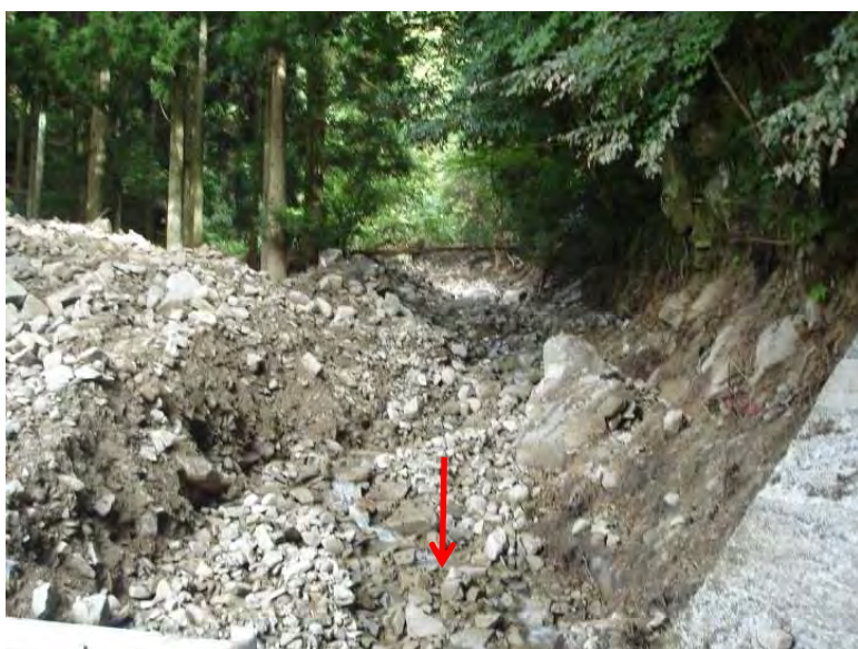
写真-2 道路左側（上流側）溪流部の土石流堆積物
