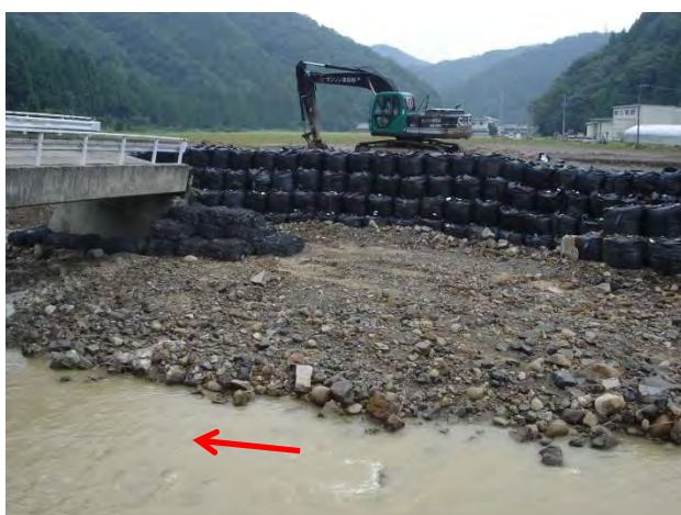
写真-5 上流側からみた損壊橋梁
