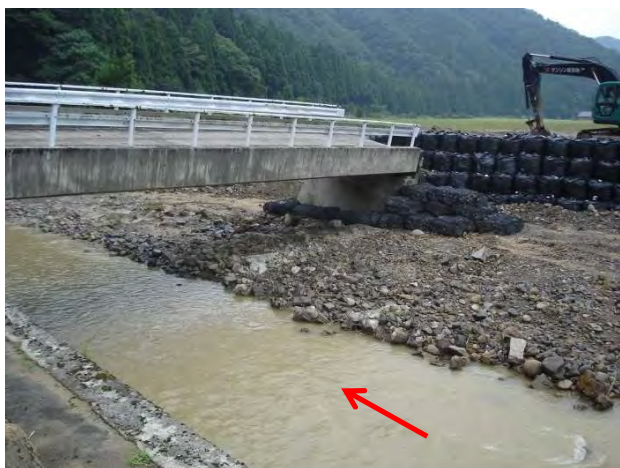
写真-4 上流側からみた損壊橋梁
