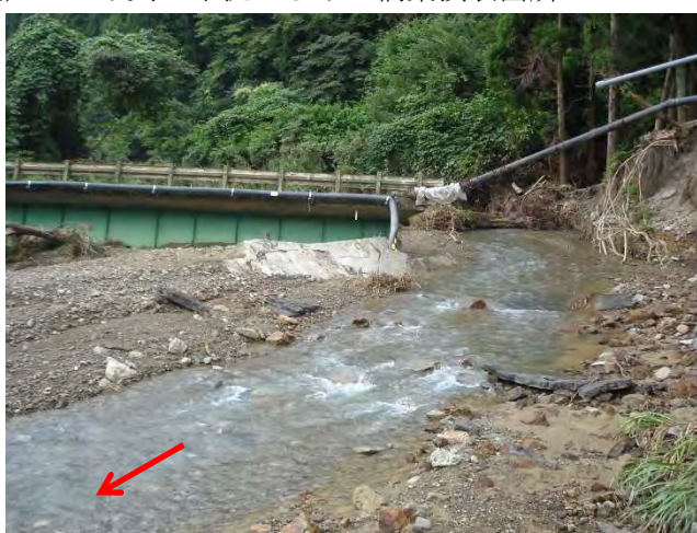
写真-6 下流からみた橋梁損壊箇所
