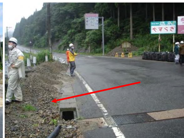
写真-5 土砂流出痕
