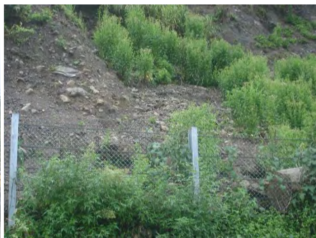
写真-7 表層崩壊
