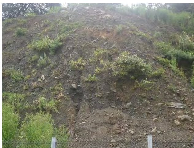
写真-9 表層崩壊
