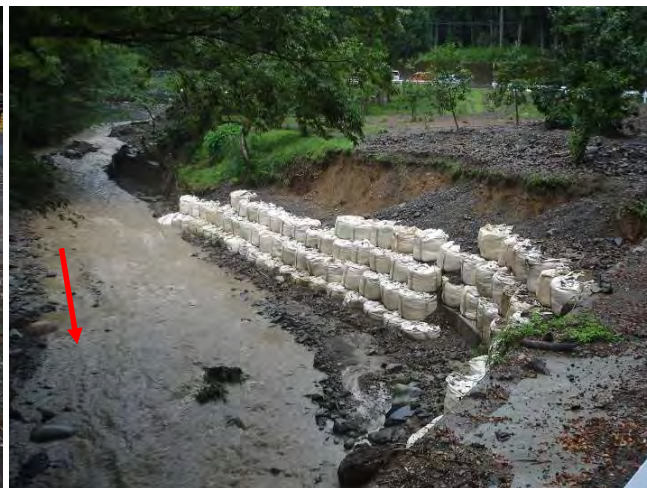
写真-3 護岸損壊
