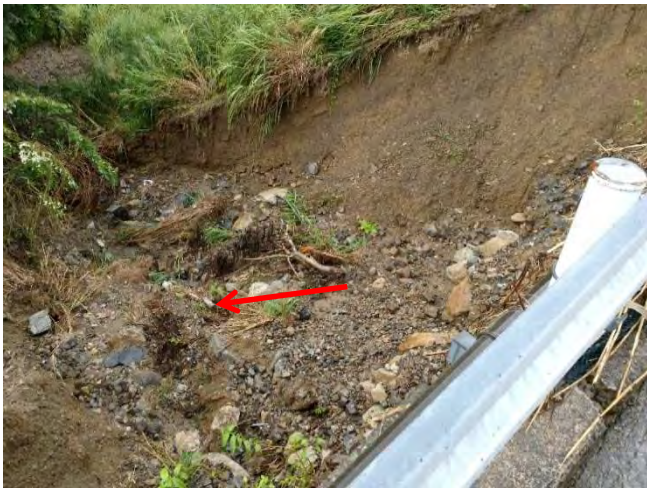
写真-8 写真-6 の表層崩壊②
