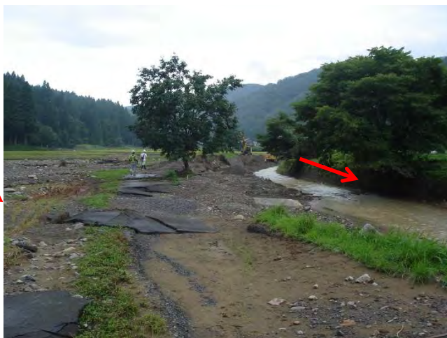
写真-13 土砂堆積箇所 舗装損傷
