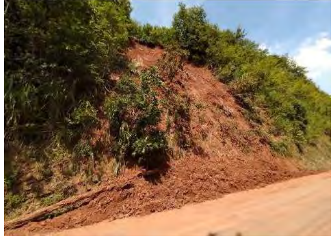
被災 No. 市 10 法面崩壊
