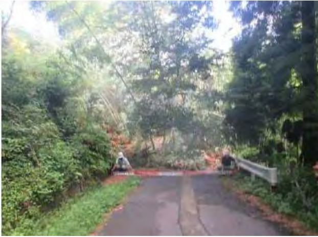
被災 No. 市 7 法面崩壊
