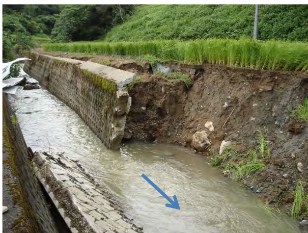
写真-9 崩壊箇所上流の護岸
