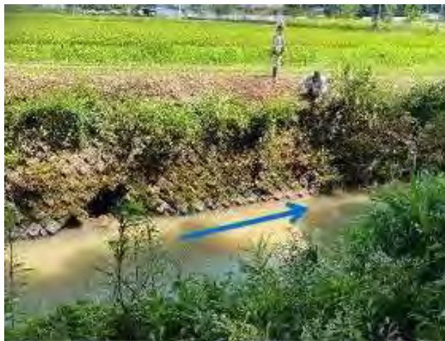
写真-2 下流部左岸側の護岸破損
