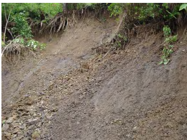
写真-8 湧水状況
