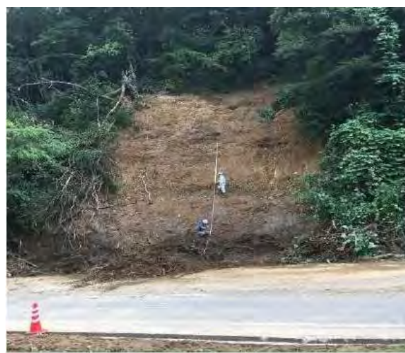
被災 No.65 自然法面崩壊
