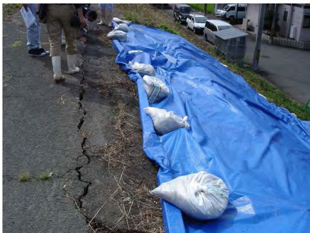
写真-3 崩壊部上部の新しい亀裂
