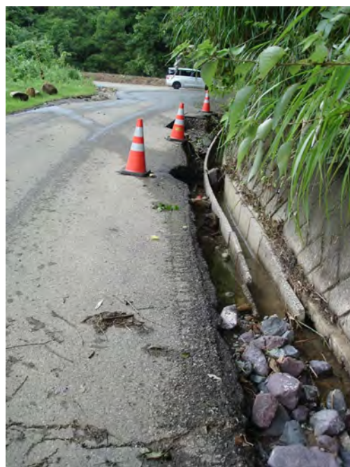
写真-10 下流部からみた側溝破損（山側）
