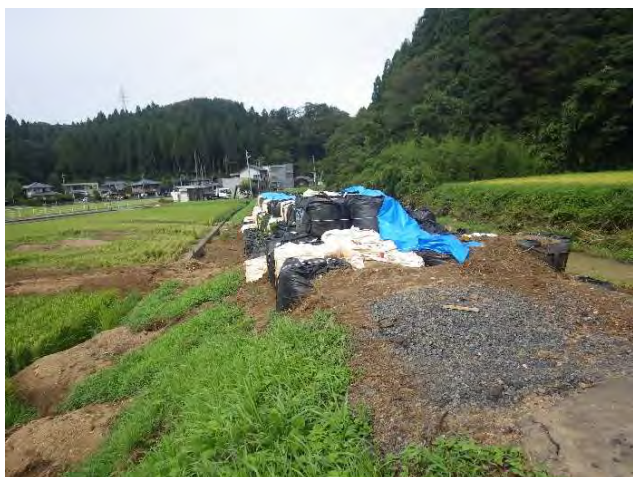
写真-6 決壊箇所上流部
