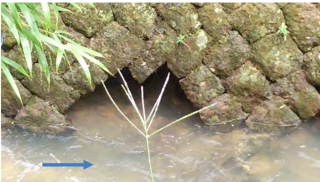
写真-6 左岸側被災箇所
