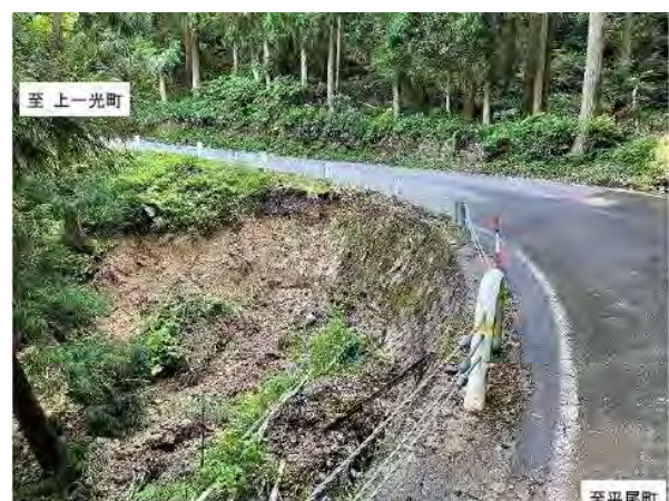
被災 No.60 路肩崩壊
