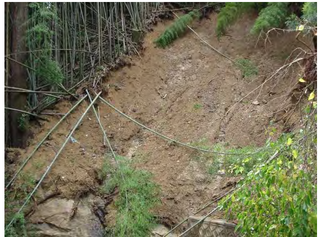
写真-6 崩壊斜面（左岸）上部
