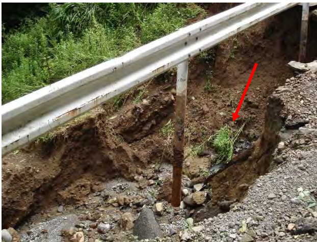
写真-9 路肩崩壊（谷側）
