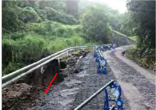
写真-8 溢水による洗堀（谷側）
