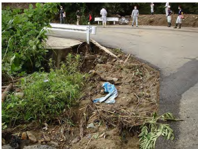
写真-7 道路横断暗渠管（下流側）路肩崩壊
