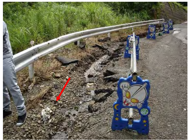
写真-6 溢水による洗堀（谷側）
