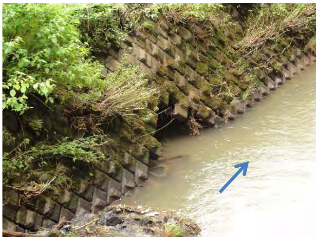
写真-1 下流部左岸側の護岸破損
