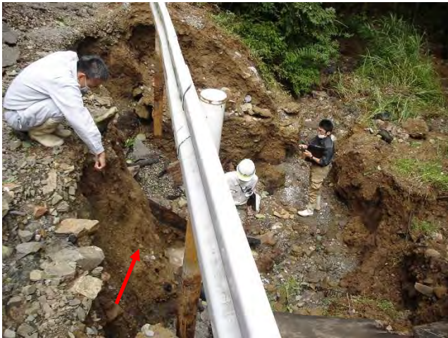
写真-11 路肩崩壊（谷側）
