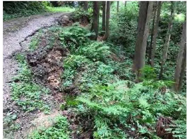
被災 No. 市 11 路肩崩壊
