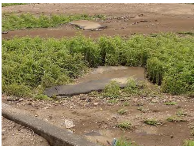
写真-10 流されたアスファルト舗装
