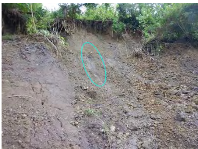
写真-6 崩壊面中央部の湧水
