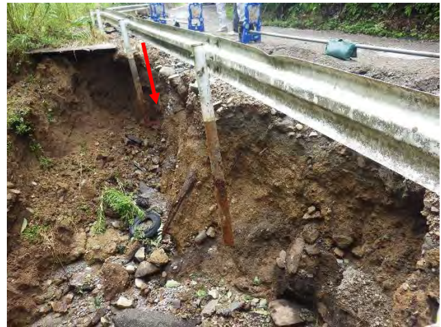
写真-12 路肩崩壊（谷側）
