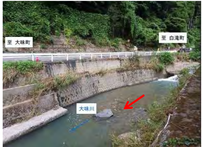
写真-4 被災直後（下流側から）
