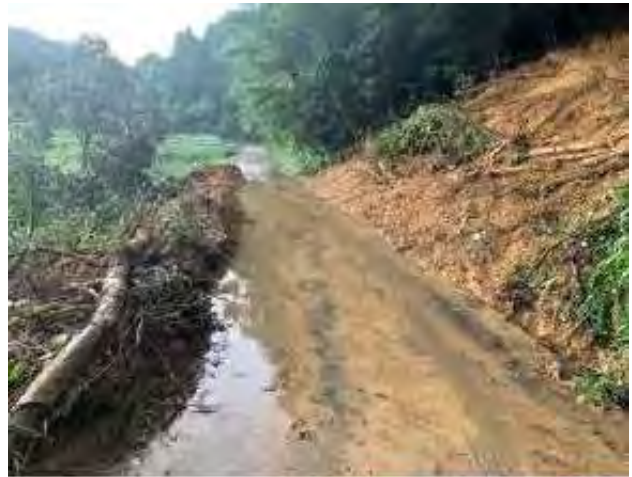
写真-2 崩壊直後
