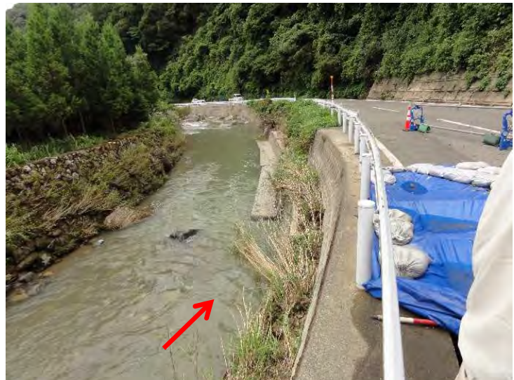
写真-6 陥没箇所（上流側から）
