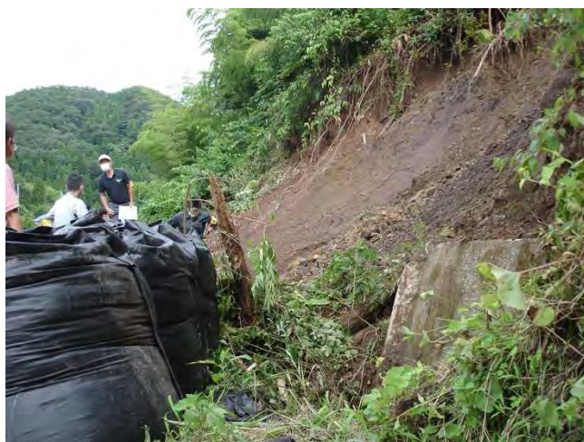
写真-13 右側部で残った擁壁
