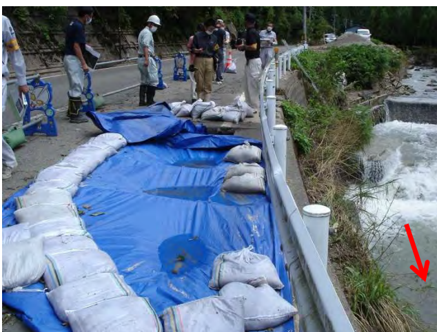
写真-11 陥没箇所（下流側から）
