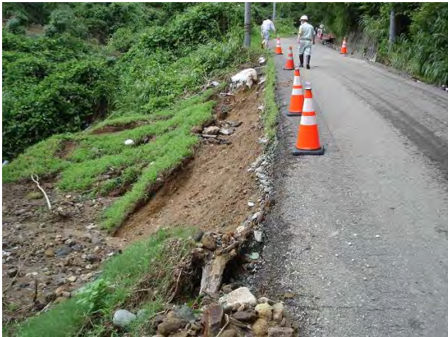
写真-11 下流部での路肩崩壊（谷側）
