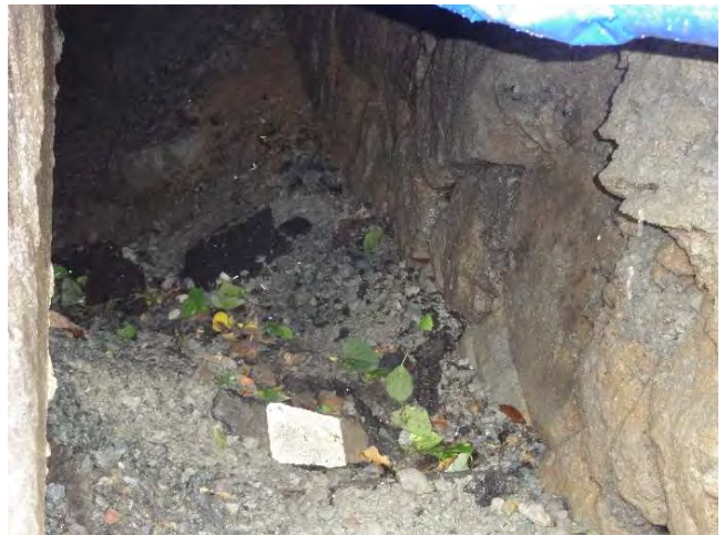
写真-10 陥没箇所内部
