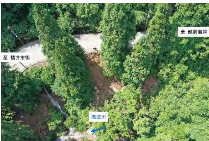
被災 No.59 路肩崩壊
