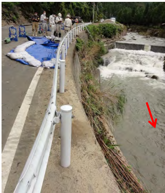
写真-5 陥没箇所（下流側から）
