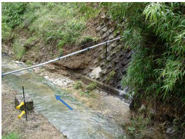
写真-7 破損した右岸側の護岸ブロック
