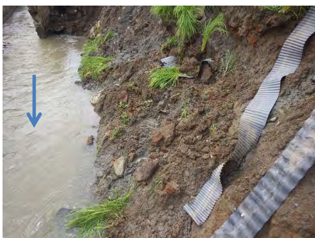
写真-7 護岸崩壊跡
