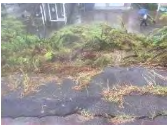
写真-5 崩壊直後（上部から）
