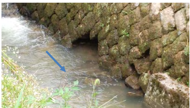
写真-5 左岸側被災箇所
