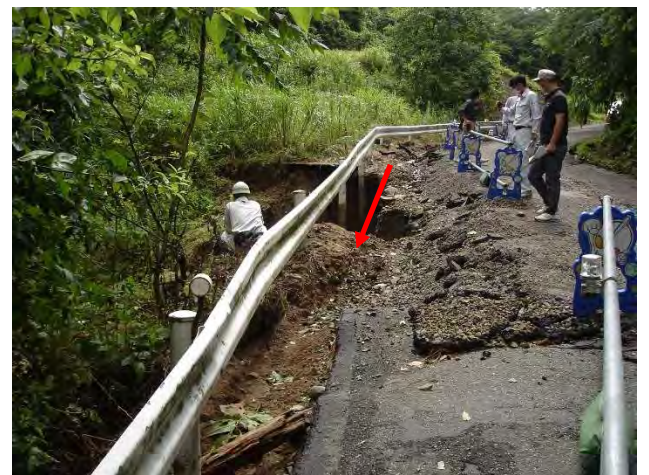
写真-10 路肩崩壊（谷側）
