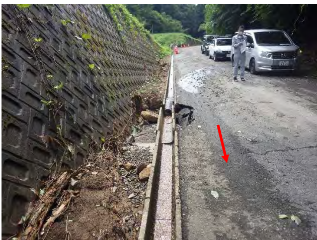
写真-3 谷側側溝の溢れと被災
