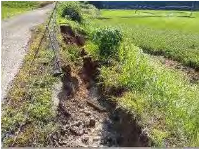
被災 No. 市 9 路肩崩壊
