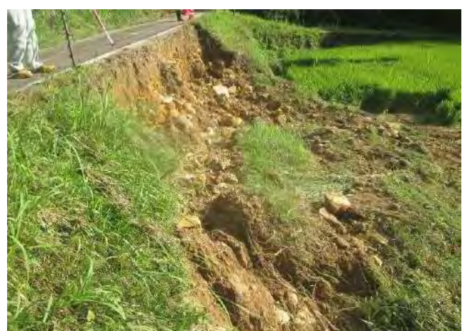
被災 No. 市 8 路肩崩壊
