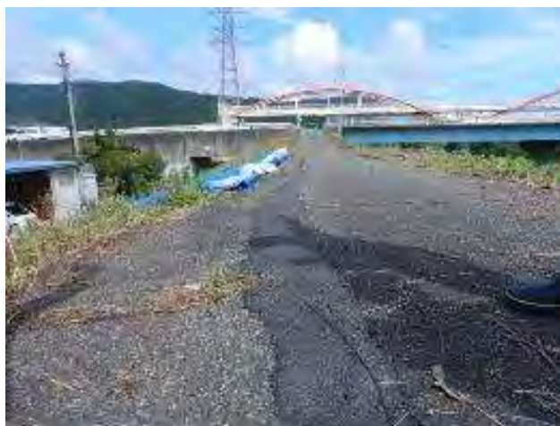
写真-4 舗装の古い亀裂と補修跡
