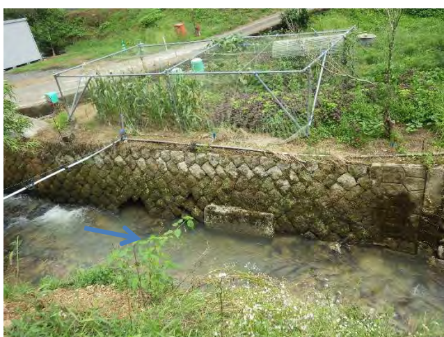
写真-3 左岸側被災箇所
