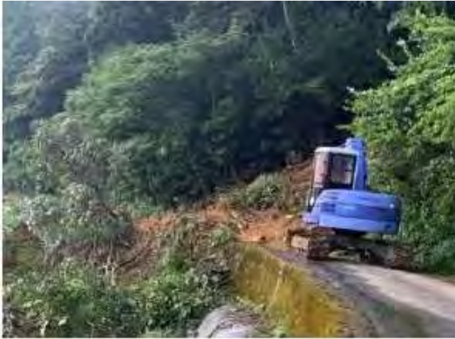
写真-1 崩壊直後
