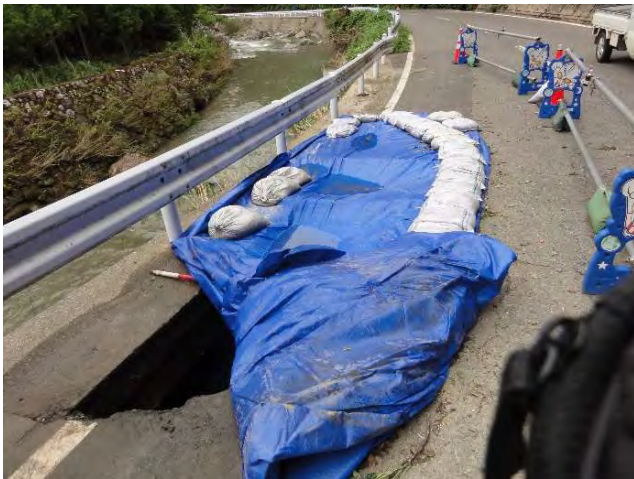
写真-9 陥没箇所（上流側から）
