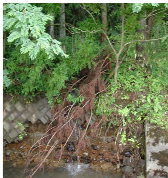
写真-9 上流部の護岸崩壊（背後の流水）
