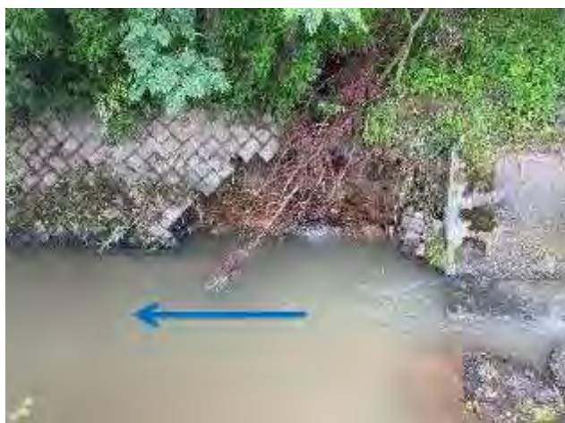
写真-7 上流部の護岸崩壊
