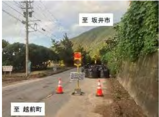
写真-4 応急復旧
