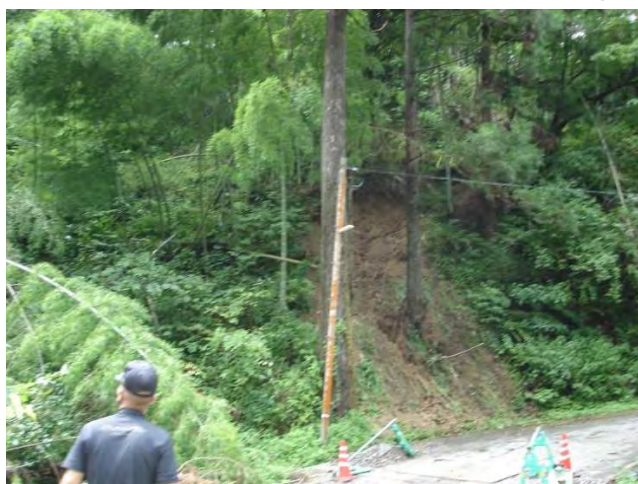
写真-15 隣接崩壊斜面
