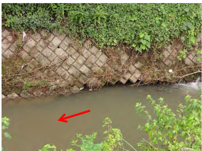
写真-3 下流部右岸側の護岸破損
