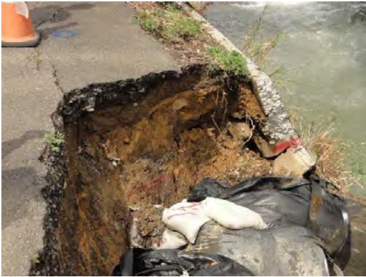
写真-7 護岸背面の崩壊部
