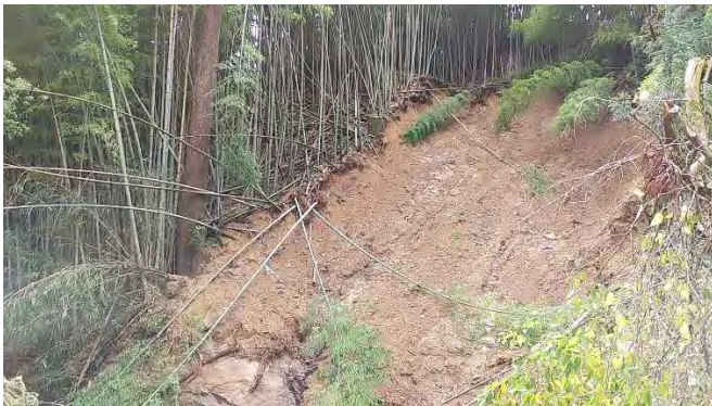
写真-5 崩壊斜面（左岸）上部
