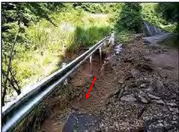
写真-7 溢水による洗堀（谷側）
