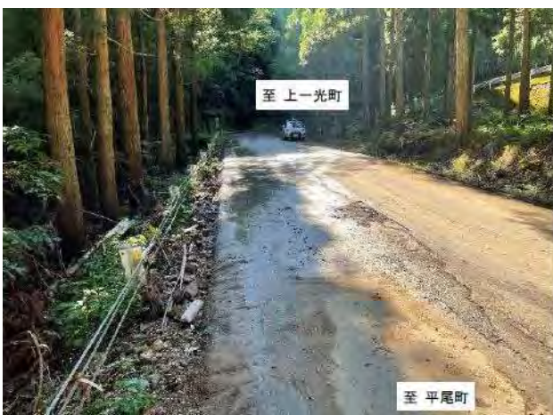
被災 No.61 路肩崩壊
