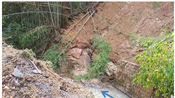
写真-10 崩壊斜面（左岸）下部の露岩
