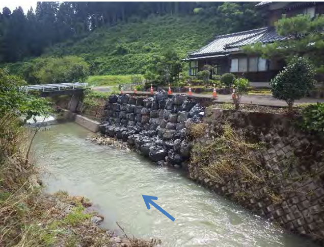
写真-3 被災箇所
