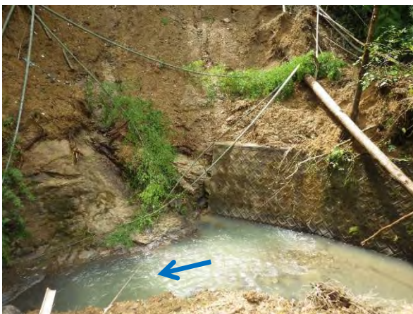
写真-9 崩壊斜面（左岸）下部の露岩
