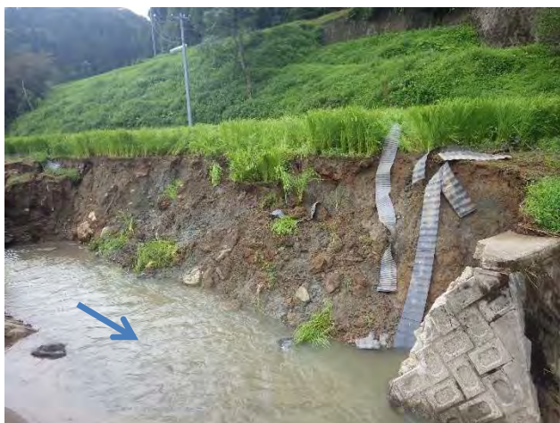
写真-5 護岸崩壊跡
