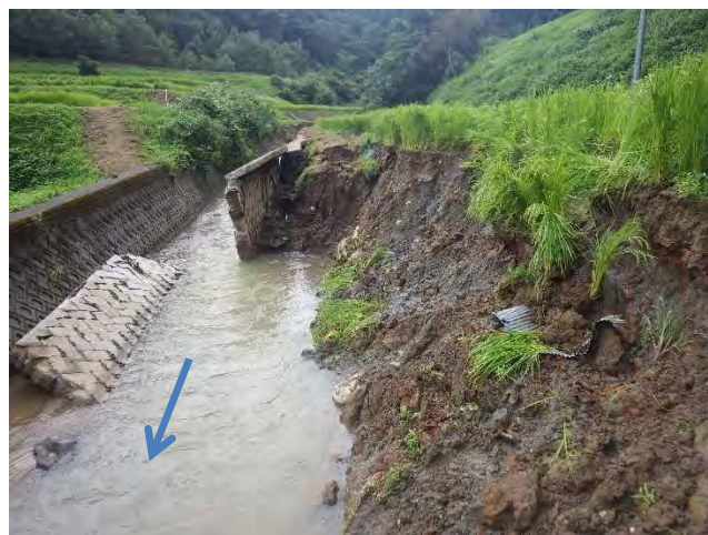
写真-6 護岸崩壊跡
