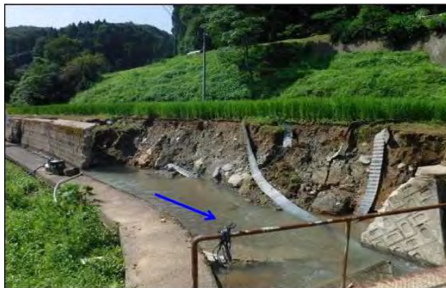
写真-4 護岸崩壊個所全景
