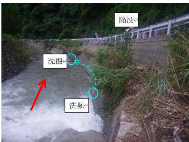
写真-7 陥没箇所（上流側から）
