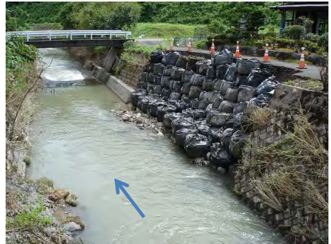
写真-4 被災箇所
