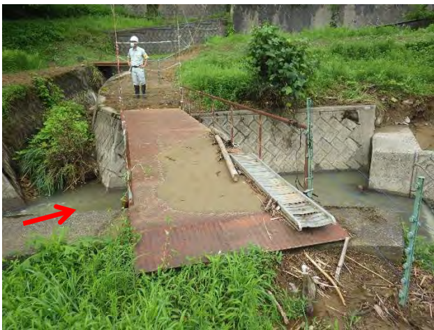
写真-13 渡り橋上の土砂痕跡
