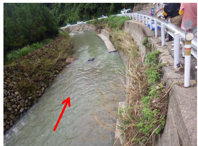
写真-8 陥没箇所（上流側から）
