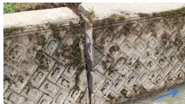
写真-10 崩壊箇所上流の護岸
