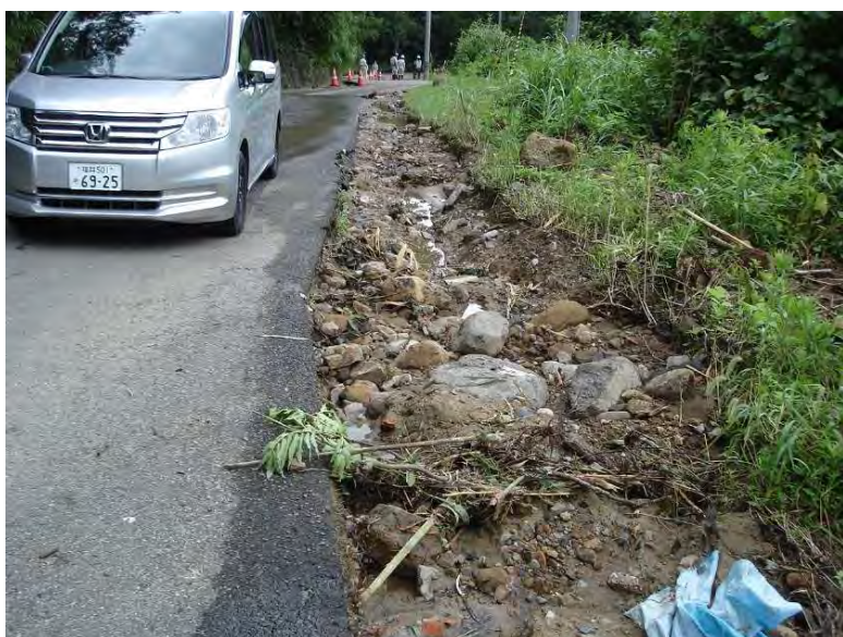
写真-9 上流部からみた路肩洗堀（谷側）
