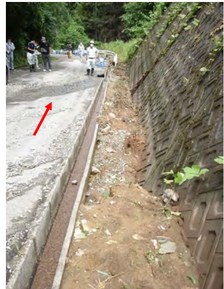
写真-2 谷側側溝の溢れ
