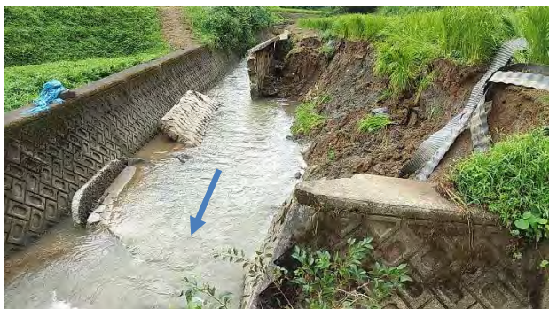
写真-3 護岸崩壊個所全景
